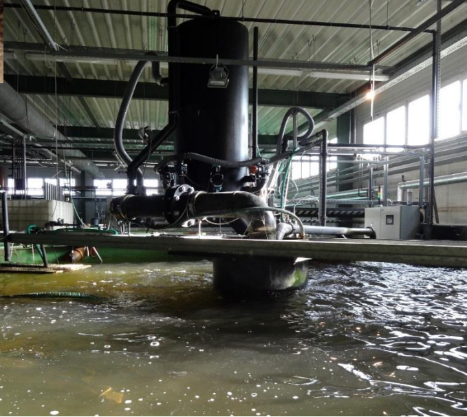
Gesamtansicht MBR (angeschlossen im Bypass am Haltungsbecken)
