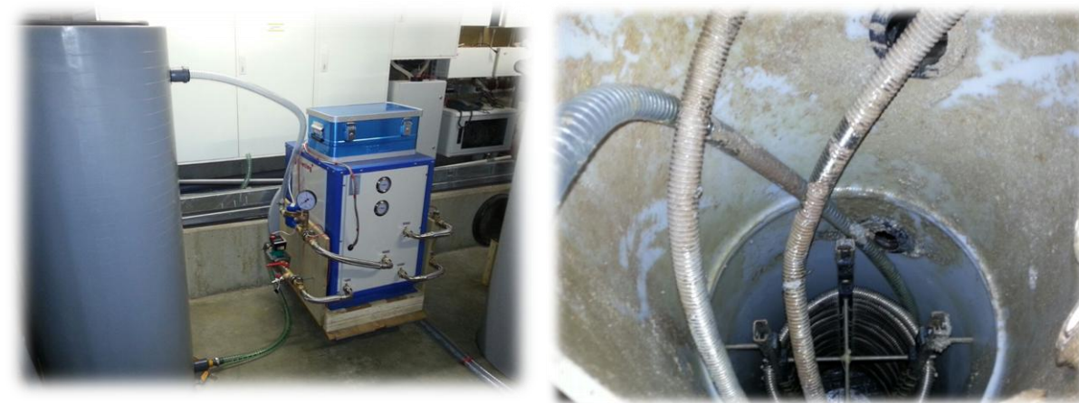
Abbildung 16: Wärmepumpe mit Pufferspeicher (links) und Blick in den Wärmetauscher (rechts).
