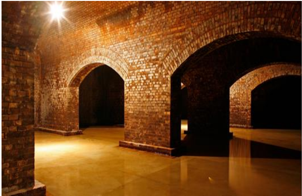
Bild 17: Blick in das Wasserreservoir, welches als Pufferspeicher genutzt werden soll. [Quelle: Nikolaus Heiss].
