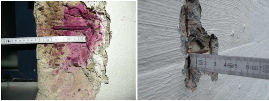
Abbildung 8: Betonaufschlüsse zur Beurteilung der Betonsanierungsmaßnahmen; Durch Besprühen der Bauteilöffnungen mit einer Phenolphthaleinlösung konnte der Karbonatisierungsgrad des Betons festgestellt werden. Violett verfärbte Bereiche stellen hierbei eine für den Stahl ausreichend alkalische Betonumgebung dar. Farblose Bereiche weisen auf einen vollständig karbonatisierten Beton hin [MBI]
