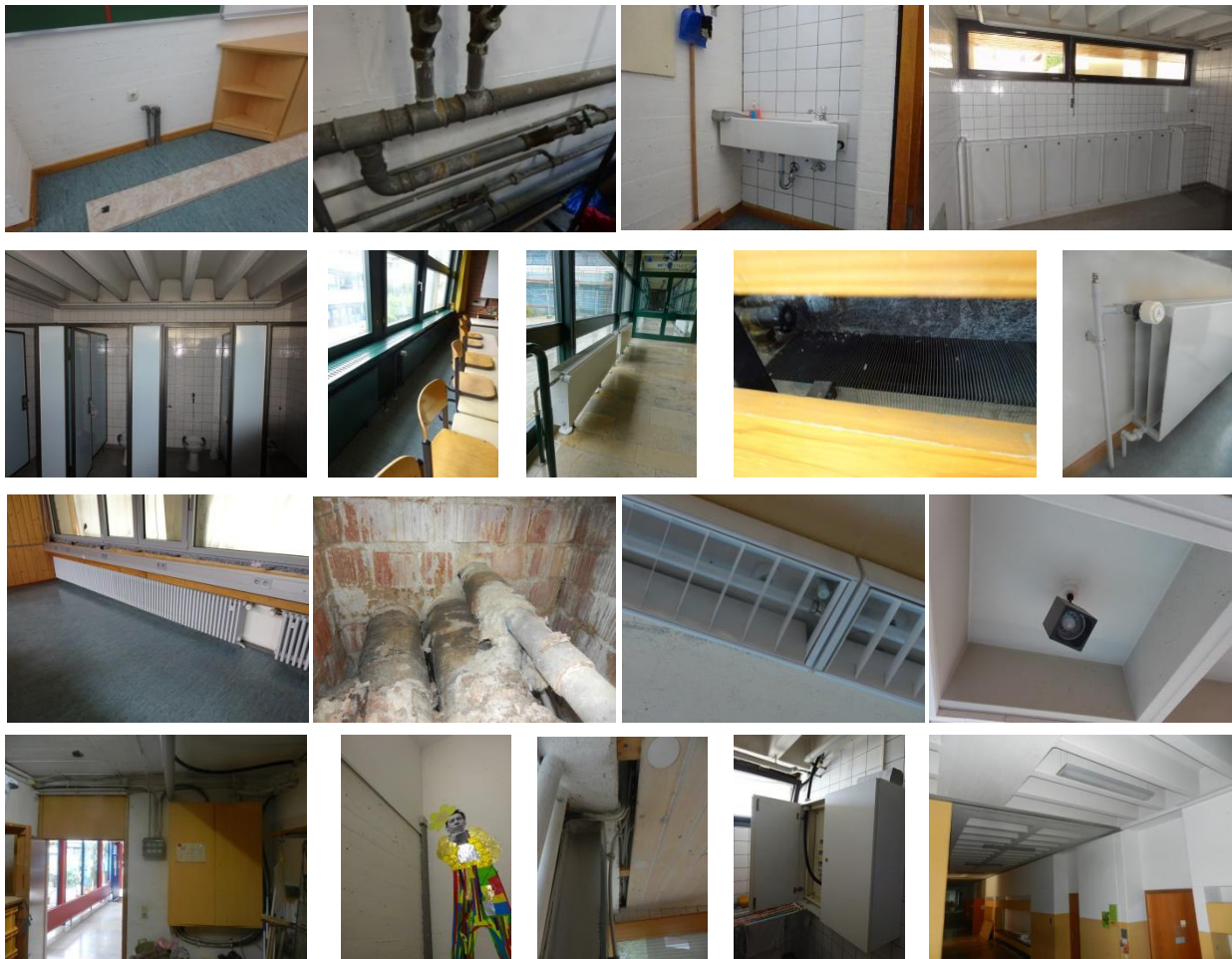
Abbildung 9: Exemplarischer Status Quo technische Gebäudeausrüstung [Architekten Keß und König]
