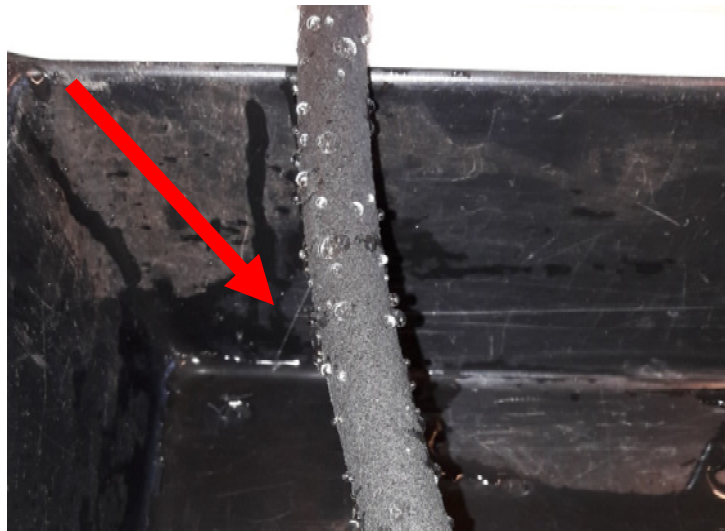
Abbildung 3: Punktuellcs Austreten größerer Wassermengen
