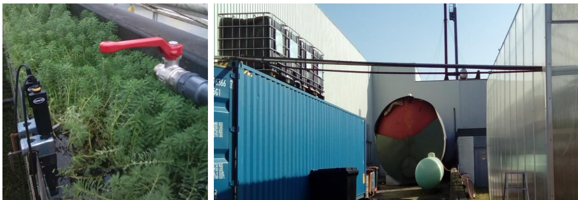
Abb. 2-3: Zulauf Reihe 1 (links), erhöhte Vorlagen und Zuleitung (rechts)
