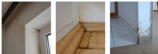
Feuchtflecken und Farbablösungen auf raumseitigen Bauteiloberflächen
