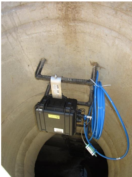
Abb. 14: Messumformer Volumenstrommessung im Schacht
