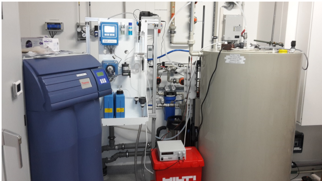
Abbildung 13: Versuchsaufbau PDI im Technikraum der Reinstwasseraufbereitungsanlage
