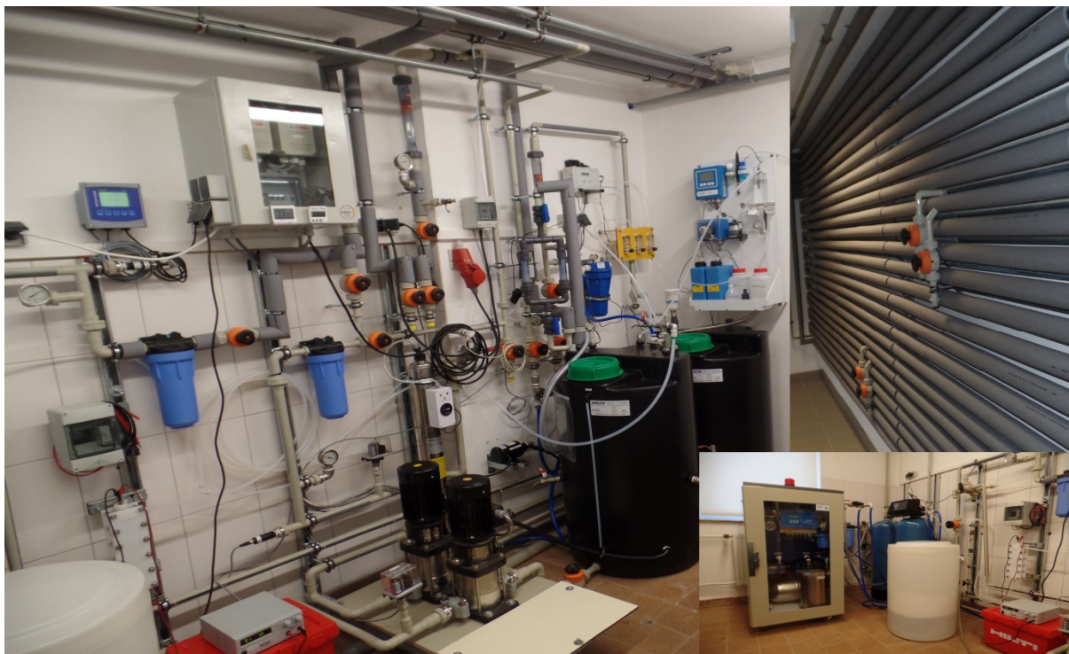
Abbildung 11: Testanlage MTJ mit Wasseraufbereitung (r. u.) und Ringleitung (r. o.)
