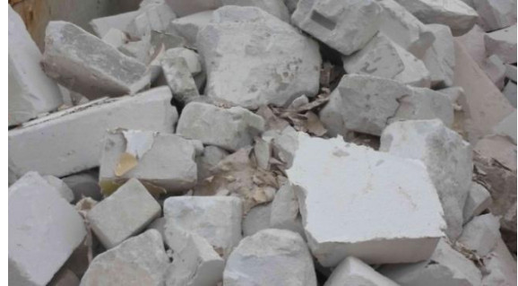
Anhang 1.2: Detail aus Anhang 1.1, Fremdbestandteile im Abbruch
