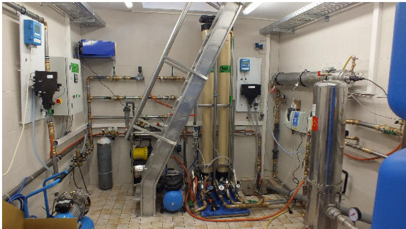
Abb. 0: Forschungsanlage mit Verfahrenstechnik und Analytik
