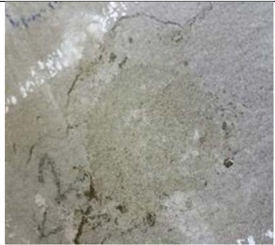
Abb. 4: Haftzugmessung an Probe DBU-BW-P1 an bereits abgeschalttem Bereich.
