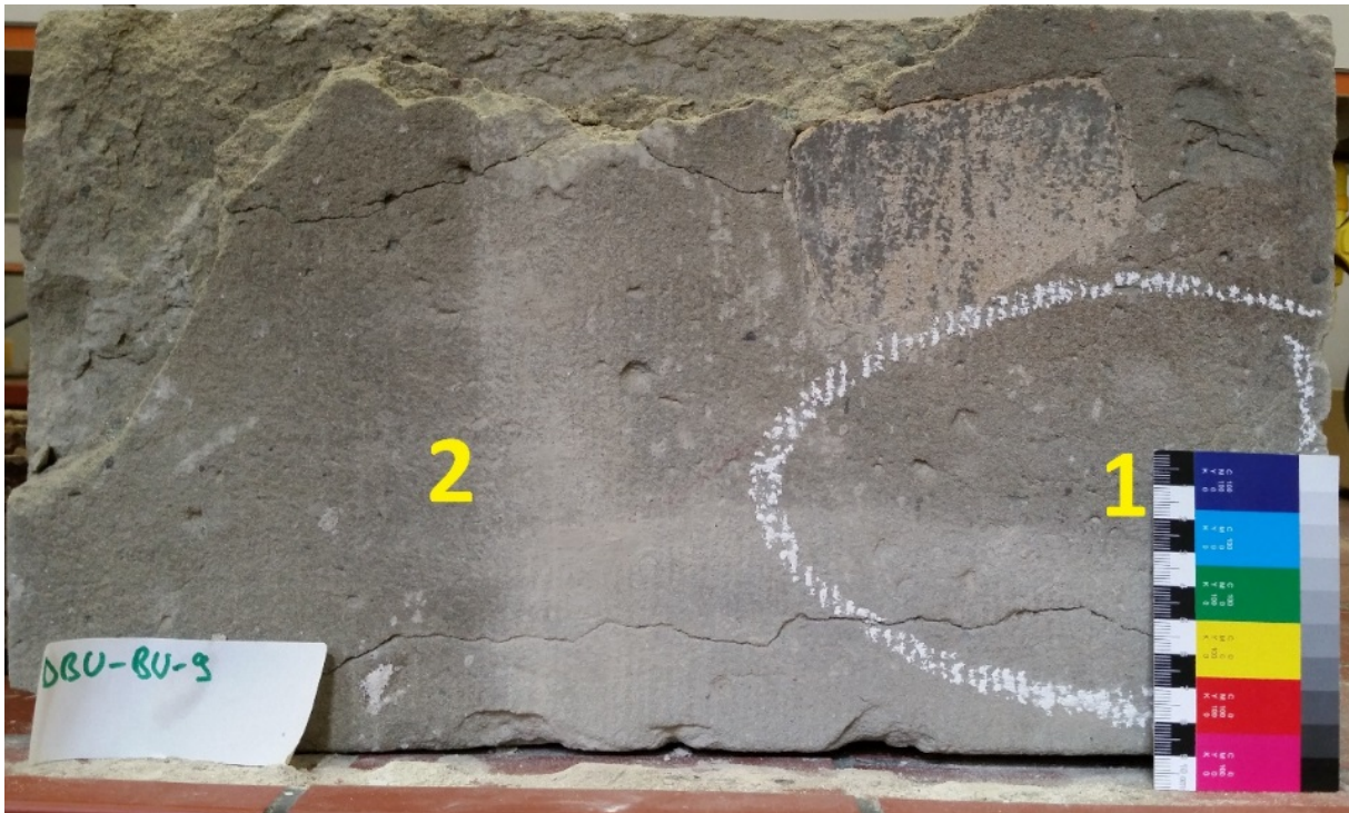
Abb. 12 Ausbauteil der Basilika Weingarten mit Schadensbilder und der Zustand vor den Haftzugtests. Deren Ergebnisse haben ca. 0,65 N/mm 2 Haftzugfestigkeit mit 5 cm Prüfstempeln und einer Abrisstiefe von max. 8 mm gezeigt. Der Bereich mit "Resthydrophobie" wurde hier weiß umgrenzt. (Hazar Colak, 2016, Masterarbeit).
