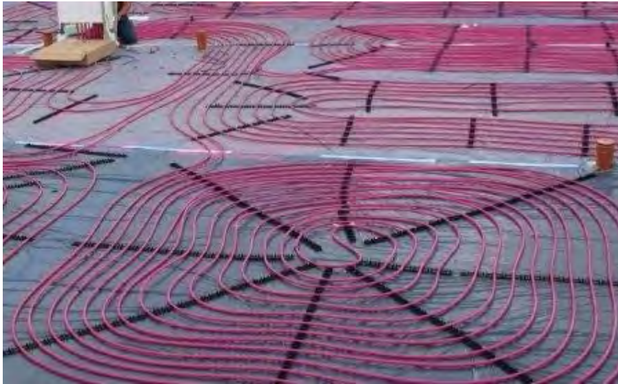
Beispiel für Betonkernaktivierung (Rohre auf Bewehrung vor dem Betonieren (Quelle Foto: [13]), spez. Kosten etwa 40 bis 50 €/m 2 [14])
