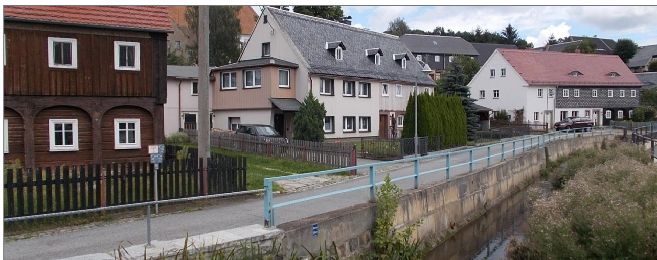
Abb. 20: Cunewalde – Ufermauer entlang des Cunewalder Wassers in Höhe „Erlenweg 3-7“
