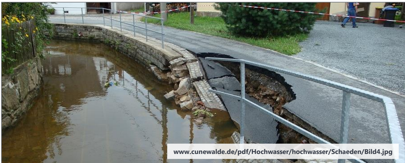
Abb. 10: Cunewalde – zerstörte Stützmauer mit dahinter liegender Straße
