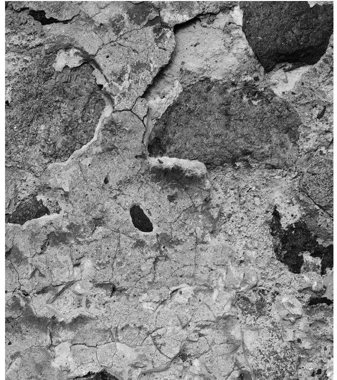
Abb. 25: Dorfkirche Niederlandin, Südfassade, Putzgestaltung mit Zirkelschlägen, Zustand 2016, Foto Sonia Cárdenas, 2016
