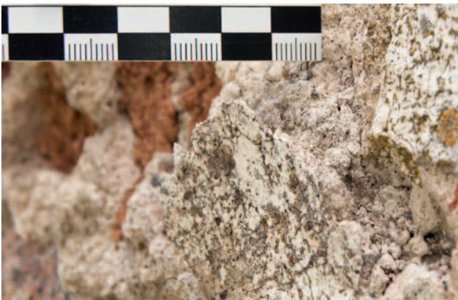
Abb. 20: Dorfkirche Kunow, Chor Ostfassade, Gefügestörung in der Randzone einer barocken Putzschale, Foto Sonia Cárdenas, 2017
