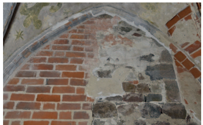
Abb. 13: Angermünde, Sakristei, Joch IV von Osten, Südwand, Übergang zwischen Feldstein- und Backsteinmauerwerk mit Putz und Architekturfassung des frühen 14. Jh., Foto Mechthild Noll-Minor, 2017
