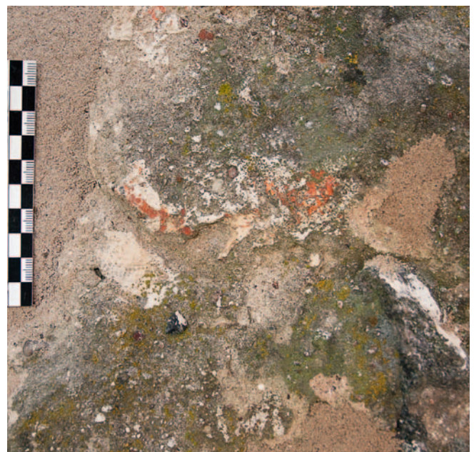
Abb. 16: Dorfkirche Kummerow, Ostfassade, biologische Besiedlung, Foto Sonia Cárdenas, 2017
