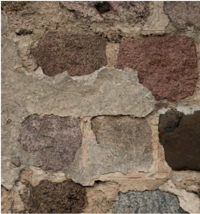
Abb. 14: Dorfkirche Niederlandin, Südfassade, mittelalterliche Fugengestaltung mit darüberliegendem Putz des 19. Jahrhunderts, Foto Sonia Cárdenas, 2016
