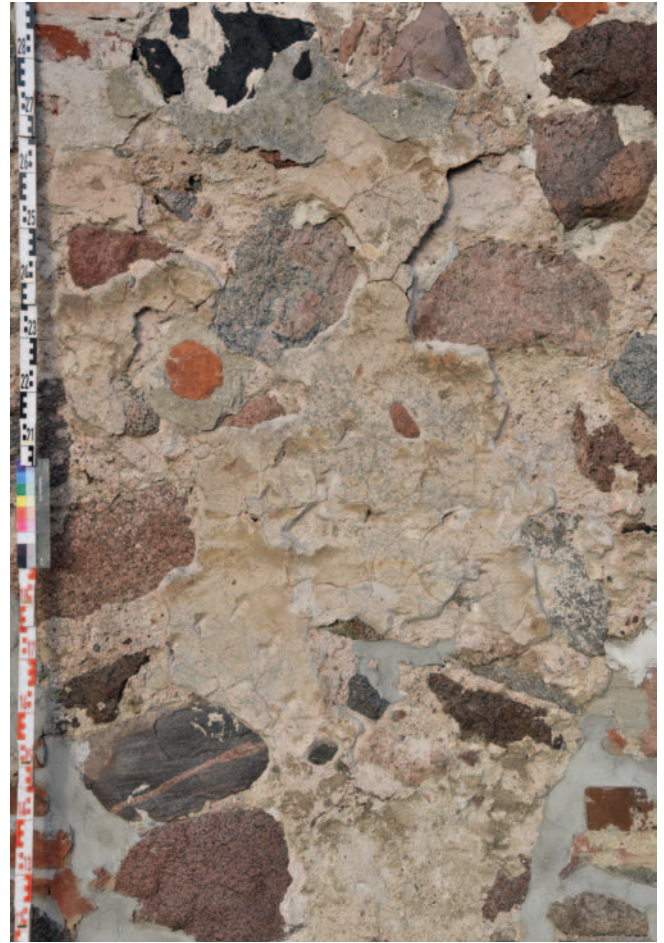
Abb. 6: Niederlandin, Putzablösungen und Putzverluste, 2016, Foto: Sonia Cárdenas
