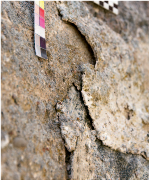
Abb. 18: Dorfkirche Kunow, Chor Ostfassade, Schalenbildung am barocken Putz im cm-Bereich, Foto Sonia Cárdenas, 2017
