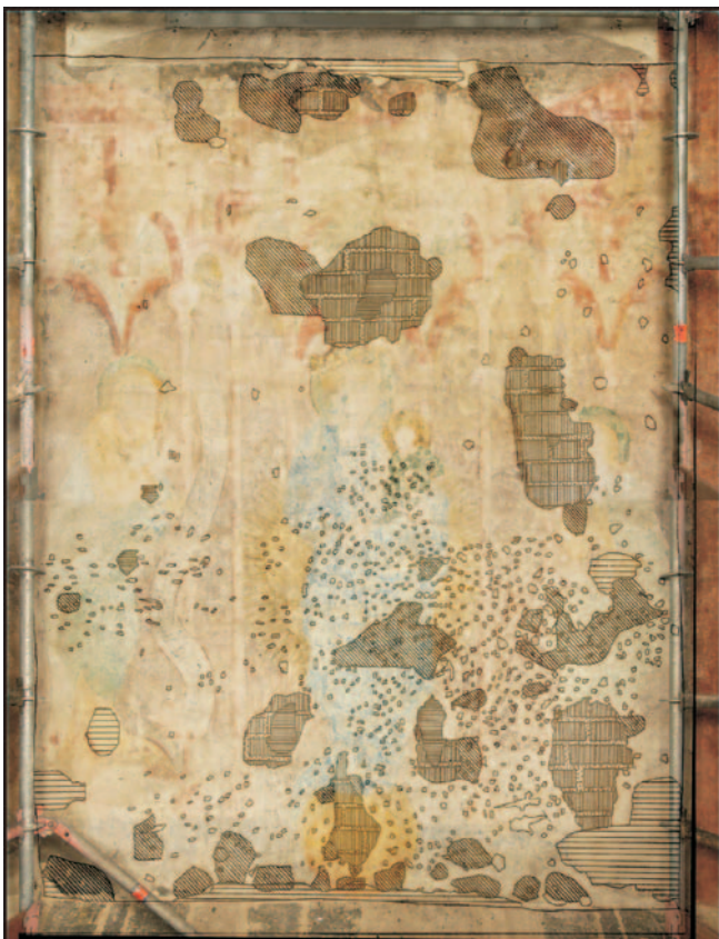
Abb. 6: Frankfurt (Oder), Marienkirche, Mondsichelmadonna, Bestands- und Schadenskartierung 1997, Kartierung Jan Raue, hier übertragen auf Foto 2016. (Bestand: horizontale Schraffuren - vorgefundene Reparaturmörtel a und b, vertikale Schraffur – backsteinsichtige Putzfehlstellen, kleinteilig-inselförmige Struktur – Hacklöcher im mittelalterlichen Putz; Maßnahmen: diagonale Schraffur: Sicherung von Putzhohllagen durch Mörtelinjektion)
