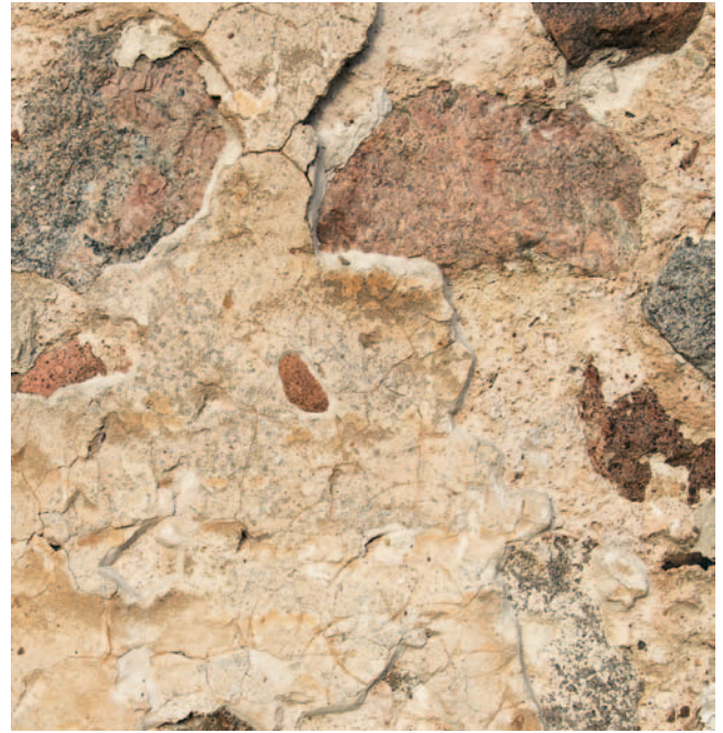
Abb. 38: Dorfkirche Niederlandin, Südfassade, fortschreitende Verformung des Putzes nach der Konservierung im Jahre 2003, Foto Sonia Cárdenas 2017
