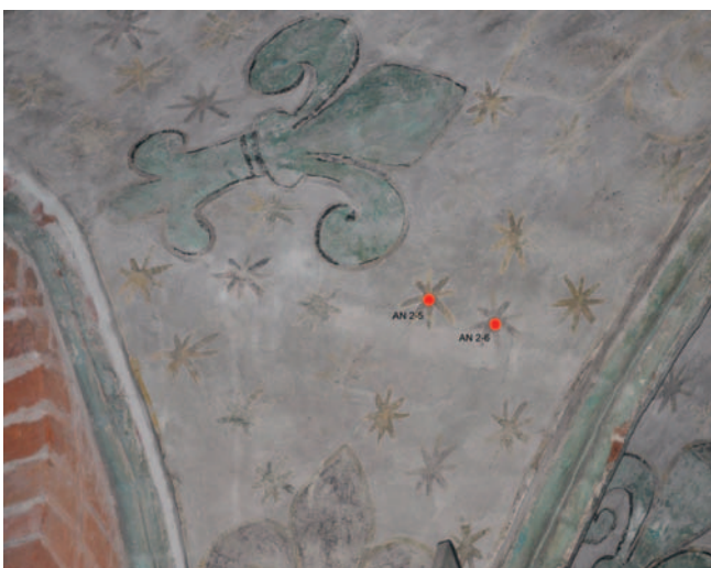
Abb. 9: Angermünde, Franziskanerklosterkirche, Sakristei, Joch II zur Südwestwand, Detail C, Lokalisierung der Messpunkte bzw. der Probenentnahmestellen (RFA, REM/EDX und Raman)
