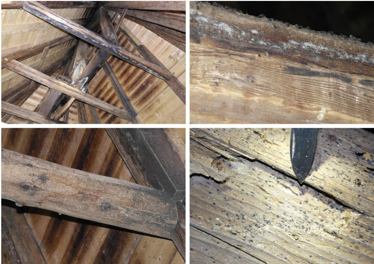
Abbildung 45. Günserode, Kirche, unterhalb des Hangplatzes (Großes Mausohr). In der oberen Reihe sind helle Flecken zu erkennen (Probe 1 – Schimmel und Salzausblühungen) und in der unteren Reihe sind dunkle Punkte erkennbar (Probe 5), die sich ebenfalls als Schimmelpilz identifizieren ließen.
