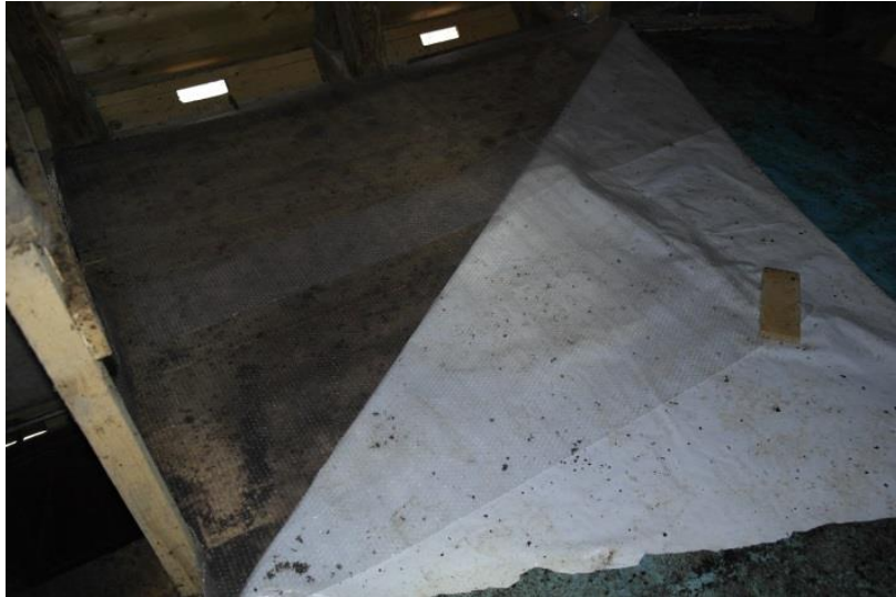
Abbildung 86 Aufgrund der hohen Feuchtwerte am 03.02.2016 wurde die Teichfolie in diesem Bereich zurückgeschlagen und eine Musterfläche mit Luftpolsterfolie angelegt.
