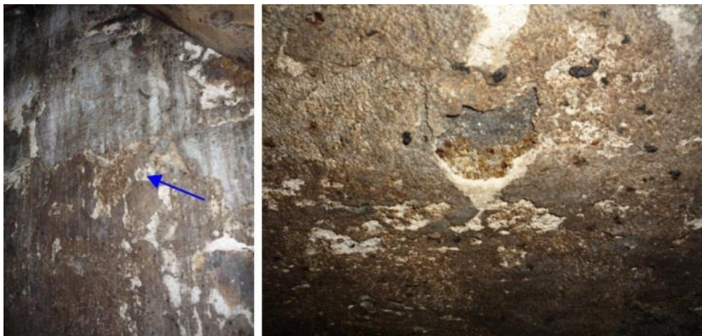
Abbildung 61. Bereich des Hangplatzes der Großen Mausohren im Dachboden der Kirche in Großjena (Großes Mausohr). Der Putz liegt stellenweise hohl; zahlreiche Wanzen sind vorhanden (Probenahmen am 18.02.2016).
