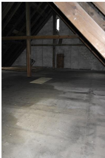
Abbildung 79. Feuchte Bereiche auf dem Boden.
