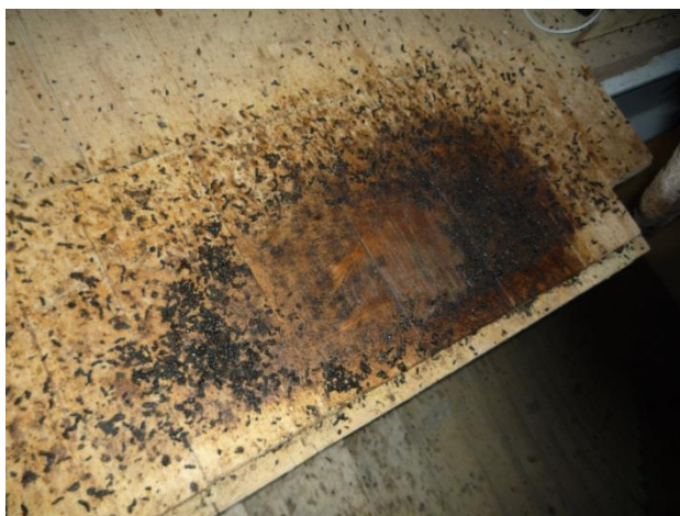
Abbildung 77. Durch Kot und Urin belasteter Bereich direkt neben der Eingangsluke; der Feuchteintrag ist deutlich zu erkennen.
