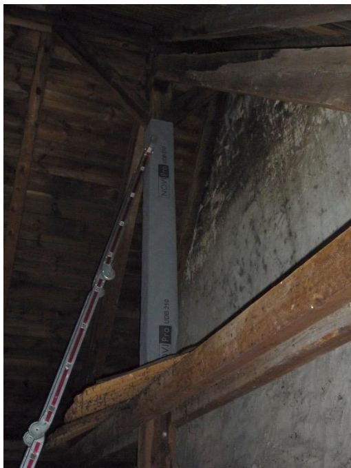
Abbildung 83. Unterspannbahn an vertikalem Balken im Bereich des Haupthangplatzes. Das Klimagerät befindet sich unter der Einhüllung, auf der dem Mauerwerk zugewandten Seite des Balkens.
