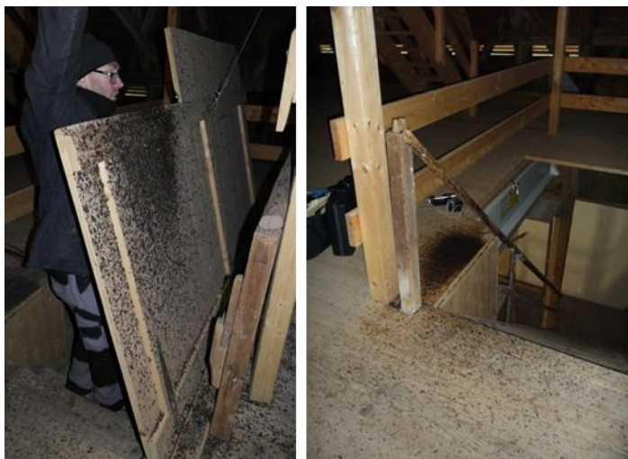
Abbildung 76. Durch Kot und Urin belasteter Bereich auf und direkt neben der Eingangsluke.
