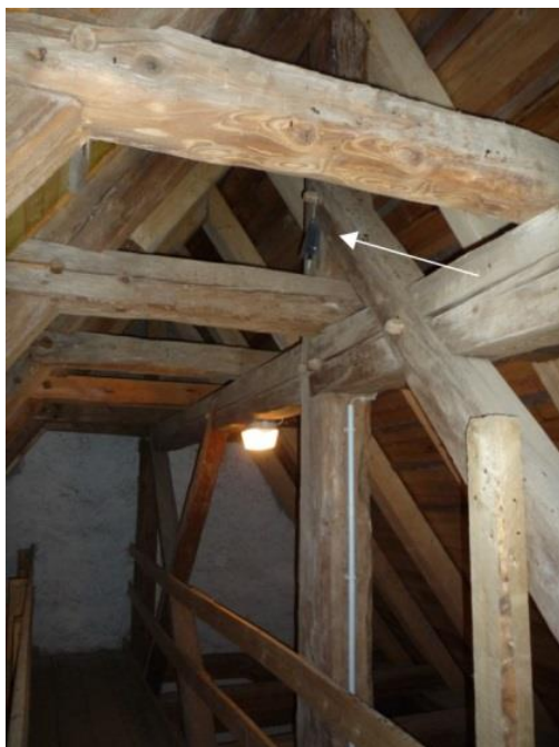
Abbildung 71. Lokalisierung des Datenloggers zur Erfassung des Raumklimas.
