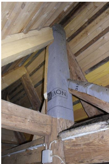
Abbildung 73. Unterspannbahn an vertikalem und schrägem Balken nach Beaufschlagung mit Exkrementen.
