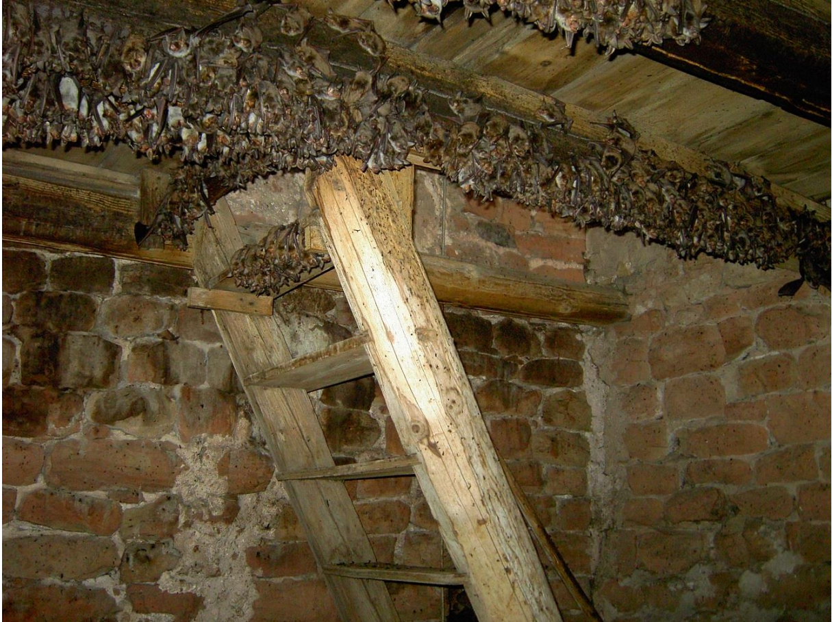
Abbildung 2. Große Mausohren in ihrem Quartier. Zu sehen sind außer den Tieren auch Kotkümel am (Leiter-) Holz sowie Verfärbungen an der Mauer und an den Holzbalken. (Foto: M. Hüpkes)
