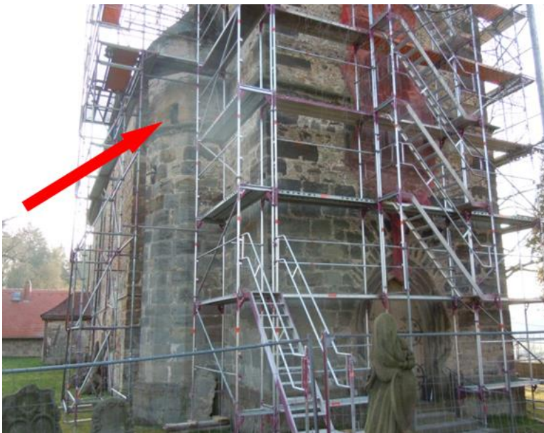
Abbildung 20. Einflug siehe Pfeil, Gerüst wurde großräumig um Öffnung freigehalten (keine Gerüststangen) und nicht mit Planen verkleidet, um Ein- und Ausflug nicht zu behindern. Der Zugang zur Baustelle im oberen Turmbereich erfolgte über einen Gerüsttreppenturm. (Foto: M. Franz)
