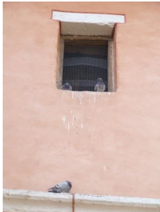
Abbildung 17. Das Aussperren von verwilderten Tauben und gleichzeitige Beibehalten von Ein- bzw. Ausflugsöffnungen für die Kleinen Hufeisennasen stellte eine der Herausforderungen dar, die für jedes Objekt eine individuelle Lösung erforderlich macht. (Foto: M. Biedermann)
