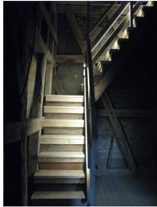
Abbildung 24. Das neue Treppenlicht im Turm wurde in der Etage mit dem Fledermaus- hangplatz speziell an die Schutzbedürfnisse angepasst. (Foto: W. Schorcht)
