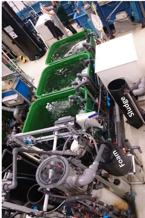
Abbildung 2. Kreislauf 2.1.1 im ZAF, ausgerüstet mit einem Klärschlammssammler (Sludge collector) und einem Schaumsammler (Foam collector).
