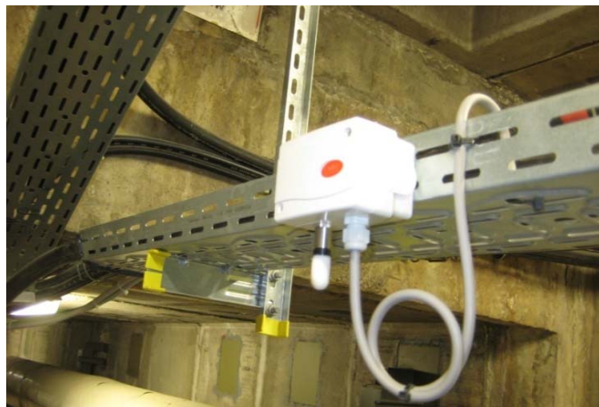
Bild B33: Beispiel Messwertgeber im Versorgungskanal
