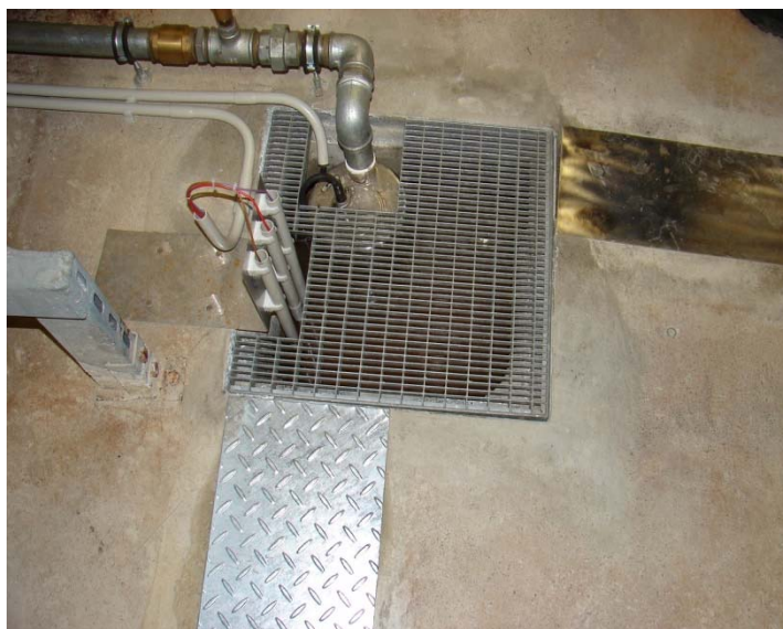
Bild B28: Flachwassersumpf mit Pumpe und 3-Stab-Sonde
