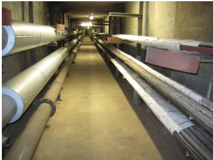
Bild B23: Einsatz von Brandsperren an Rohren und Kabeln
