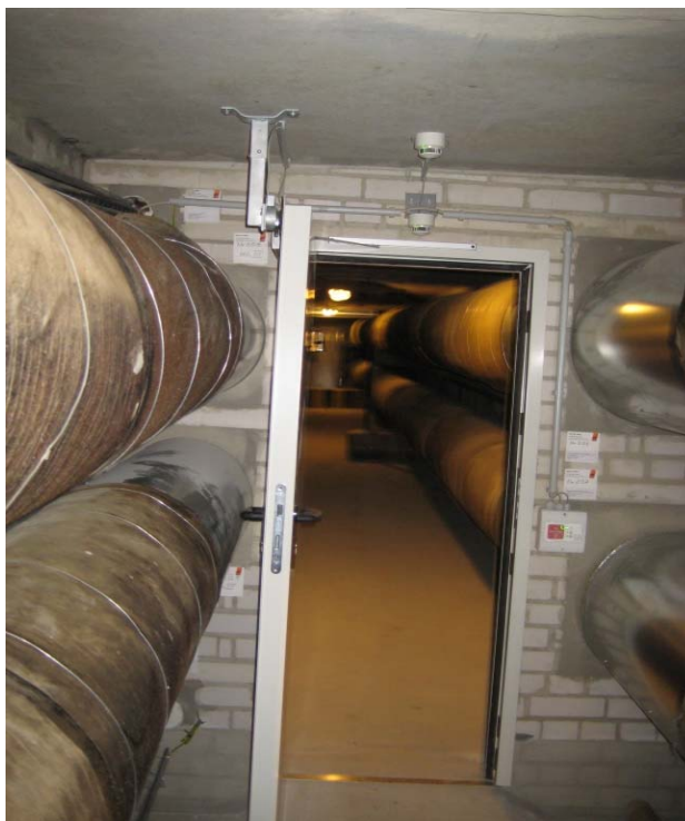
Bild B12: Beispiel Rauchmelder mit Türkontakt zur Trennung zweier Brandabschnitte in einem Lüftungsabschnitt
