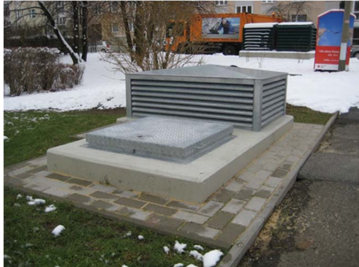
Bild B27: Beispiel einer Lüftungshaube und benachbartem Notausstieg
