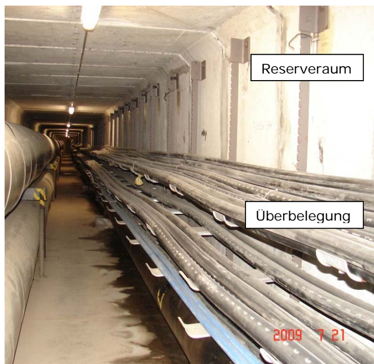
Bild B18: Bestandsbeispiel Kabeltragsystem
