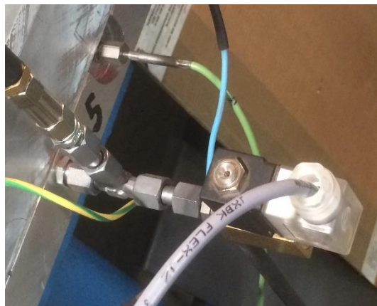
Anschlussleitung Kat. Bild 5.10.3
