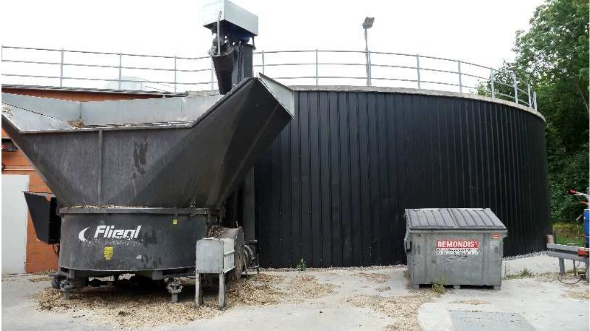
Abbildung 2.5: Anlage 5: Fermenter aus Beton mit Massivdecke
