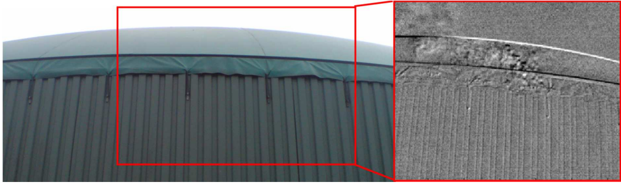
Abbildung 1.2: Beispiel für eine Gasleckage am Übergang von Foliendach zur Seitenwand eines Fermenters. Links: visuelles Bild. Rechts: Differenzbild der Gaskamera
