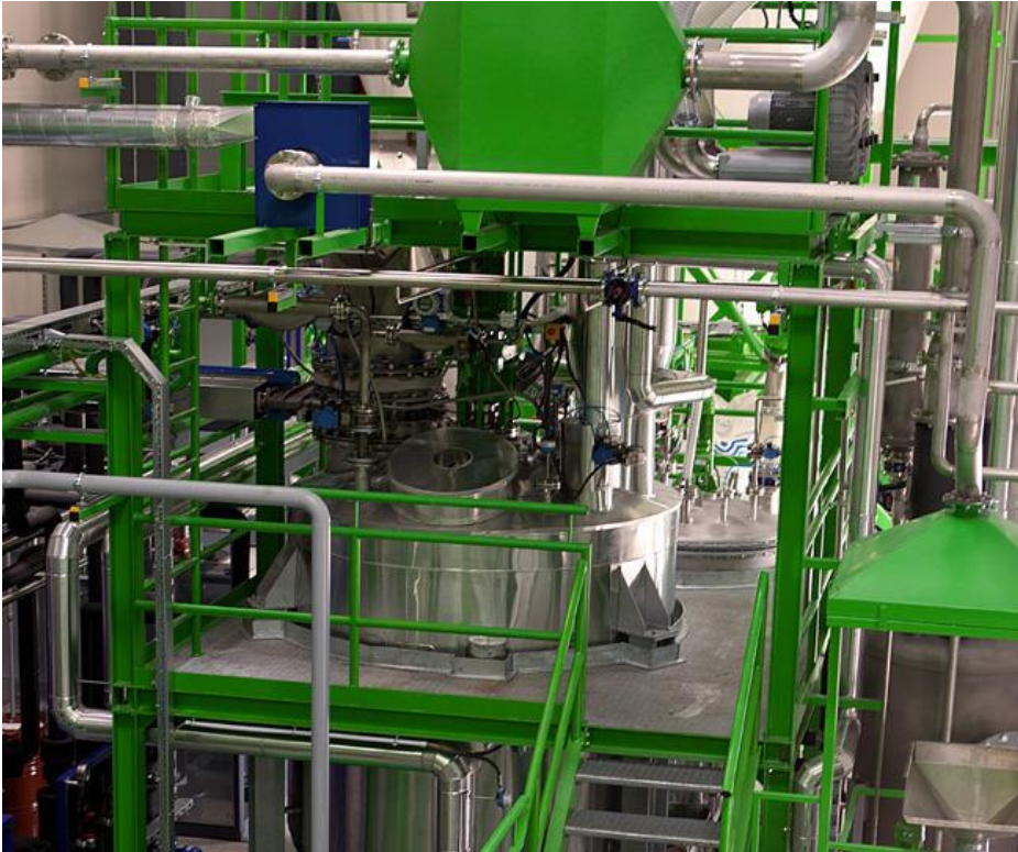
Bild 63: PUR Aufbereitungsanlage H & S Anlagentechnik GmbH, Sulingen, (copyright DBU)
