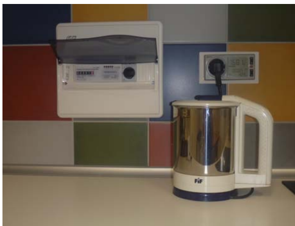
Stromzähler für Cerankochfeld und Induktionskochfeld
