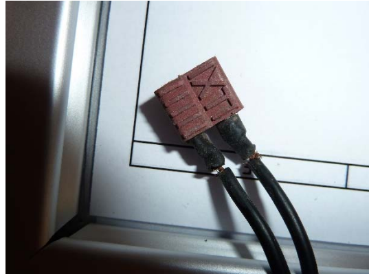
Abbildung 10: Unsachgemäße Fertigung (Holtmann)
