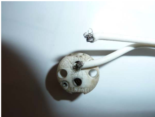
Abbildung 11: Mechanische Überlastung (Holtmann)
