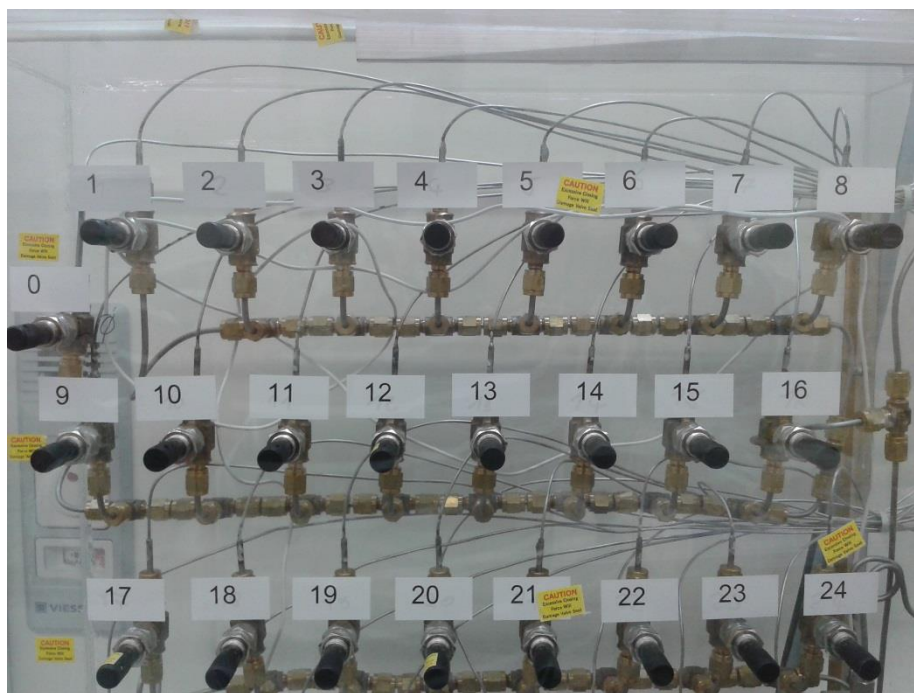
Abbildung 40: Ventile zum Einstellen der Gasflüsse
