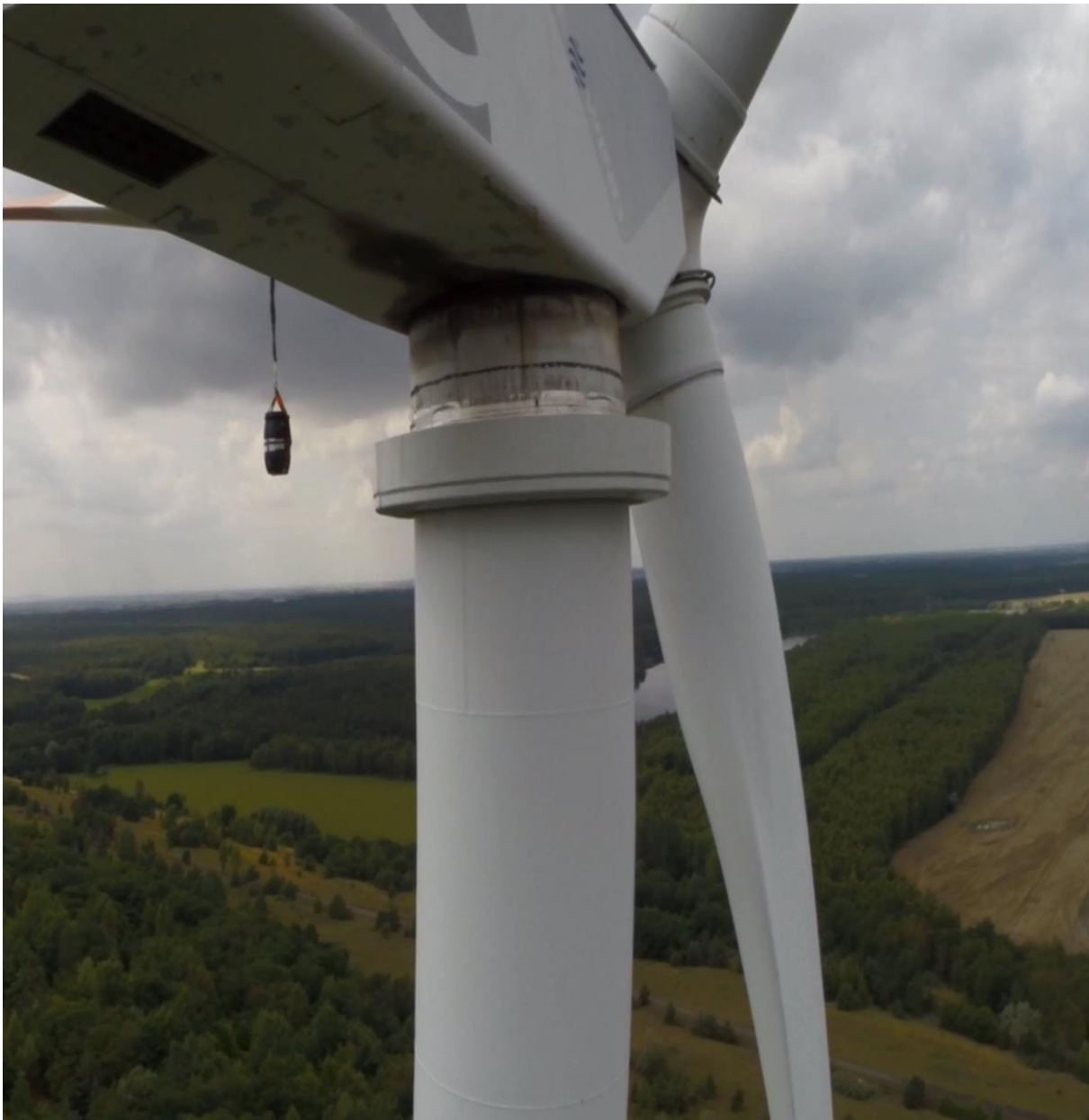
Bild 48: Spuren der Ölverunreinigungen oberhalb des OSC
