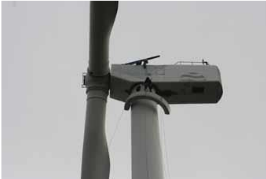
Bild 34: OSC-Halbschale unterhalb der Gondel
