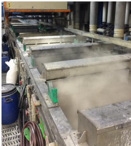
Abbildung 2: Phosphatieranlage der Schondelmaier Presswerk GmbH
