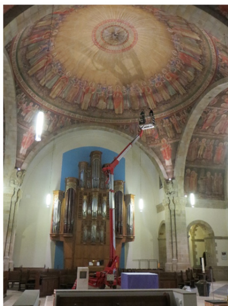
Bild 1 Hebebühne im Innenraum (April 2014, Foto: Dörthe Jakobs).
