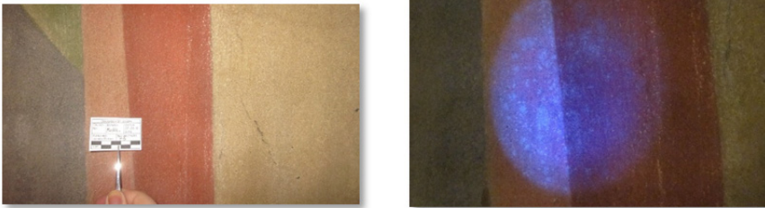
Bild 3 links: Osnabrück, St. Joseph, begleitende Fotodokumentation von Probeentnahmen zur mikrobiologischen Untersuchung rechts: Aufnahme unter UV-Licht, Oktober 2015 (Fotos: Dörthe Jakobs)
