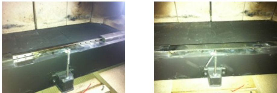
ABBILDUNG 7: PROVISORISCH EINGEBAUTE LUFTFÜHRUNG
