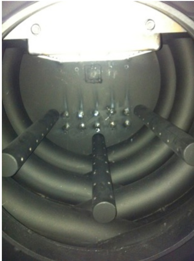
ABBILDUNG 10: NEUE LUFTZUFÜHRUNGEN IN DEN BULLERJANÖFEN
