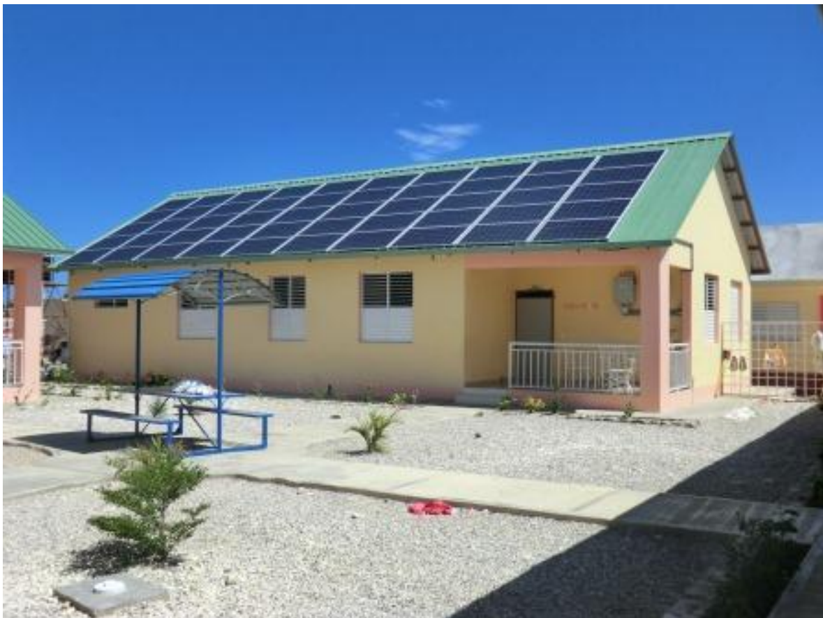
Abbildung 4: Ein Gebäude mit installierten Modulen
