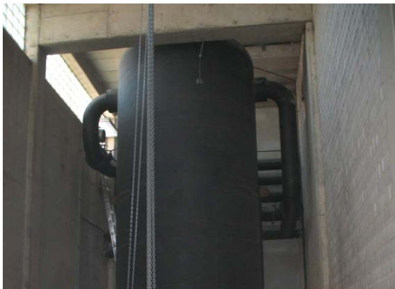
Abbildung 7: In Nabern eingesetzter Kaltwasserspeicher
