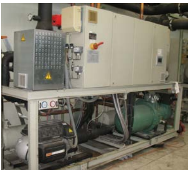
Abbildung 6: Eine der in Nabern eingesetzten Kompressionskältemaschinen
