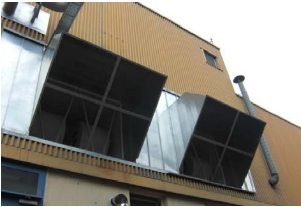
Abbildung 5: Luftansaugseite der in Nabern eingesetzten Nasskühltürme der Firma Gohl
