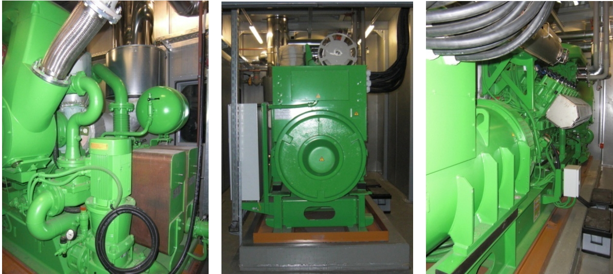
Abbildung 1: Das eingesetzte BHKW des Typs JMS 412 GS-C05
