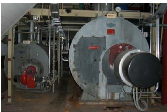
Abbildung 3: Heizkessel zur Deckung der Spitzenlast
