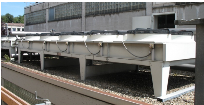
Abbildung 8: Tischkühlereinheit zur freien Kühlung
