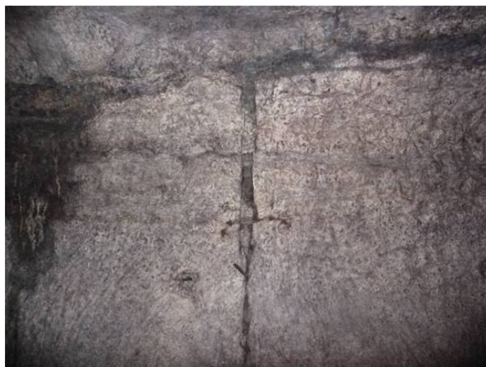
Abbildung 19: Die senkrechte Kluft in der Stollenwand (massiver Werksandstein) endet an einem dunklen Tonband und setzt sich im hangenden Sandstein der Übergangsschichten nicht mehr fort.
