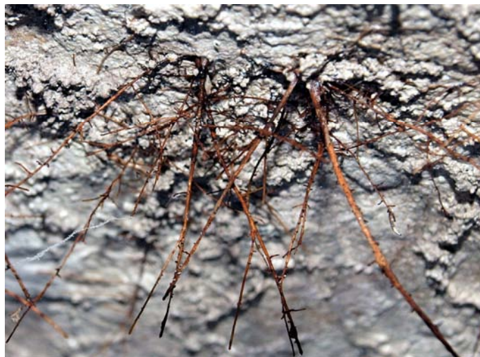
Abbildung 13: Oft geben die durchdringenden Wurzeln Hinweise auf versteckte Klüfte. Die dargestellten Wurzeln erreichen Durchmesser von ca. 1 cm. Auch weitaus dickere Wurzeln mit Durchmessern von bis zu 5 cm finden sich in den Kellern
