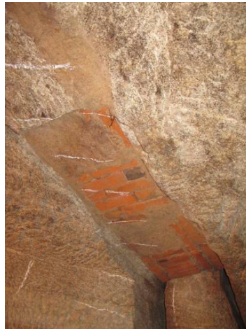
Abbildung 16: Rappenkeller: bauliche Situation an der Decke bei y = 6,50 m
