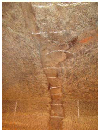
Abbildung 18: Ausbesserungen an der Decke zwischen y = 3,0 m und 4,0 m
