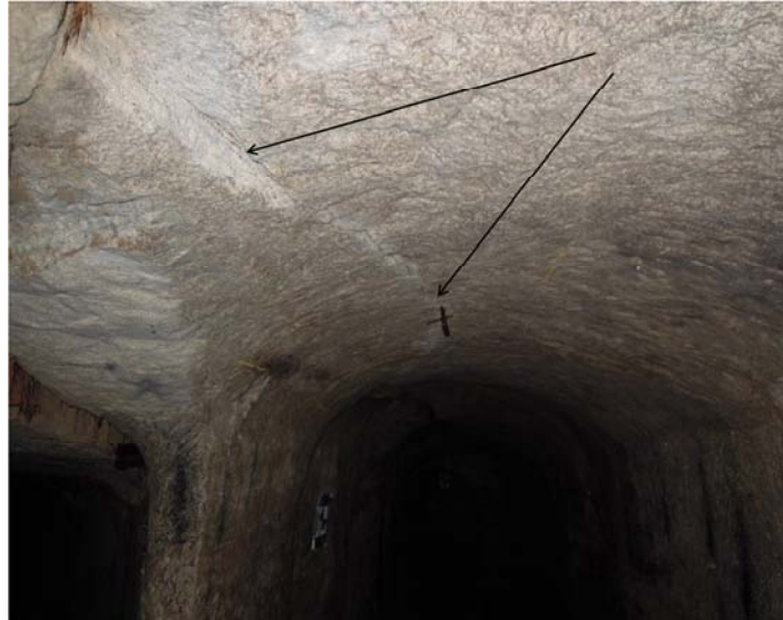
Abbildung 11: Häufige Riss- und Bruchstrukturen im Deckenbereich weisen auf statische Überbeanspruchungen hin.
