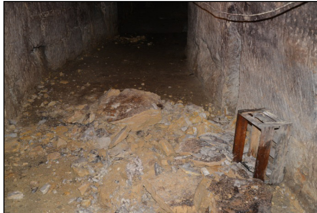
Abbildung 1: Großflächiger Firstfall im Südgang
