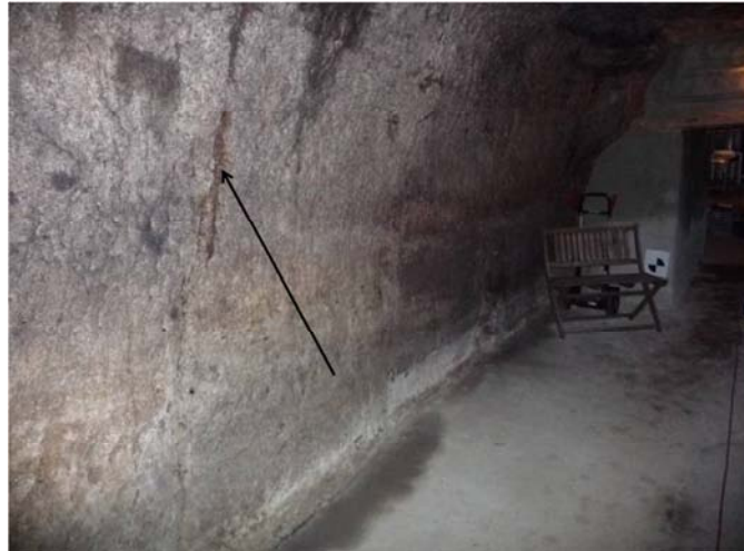
Abbildung 18: Hauptstollen; In einigen Kellerbereichen finden sich über mehrere Meter Strecke keine offenen Klüfte. Geschlossene Klüfte sind vielfach an Feuchteaustritt und feinen Durchwurzelungen zu erkennen (Pfeil).
