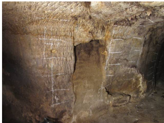
Abbildung 22: vermutlich hohl liegende Kluft in der Wand, die sich bis in das Schichtungssystem der Decke erstreckt.
