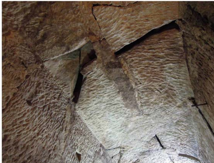
Abbildung 6: Weitstehende, meist steil einfallende Klüfte, die den Sandstein in verschiedenen Längs- und Querrichtungen zerstückeln, beeinträchtigen die Stabilität der Tunneldecke. Im Bild ist die Längskluft an der Tunneldecke weitgehend mit Mörtel verschlossen.
