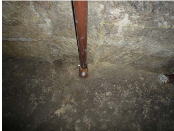
Abbildung 2: Verdübelung eines Schrägstützenfußes im Sandstein.
