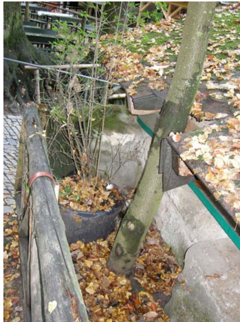
Abbildung 8: An diesem Standort hat die Lind keine Zukunft, da die sich unter dem Dach befindliche Schankterrasse bzw. deren Böschungsmauer gefährdet werden würde.
