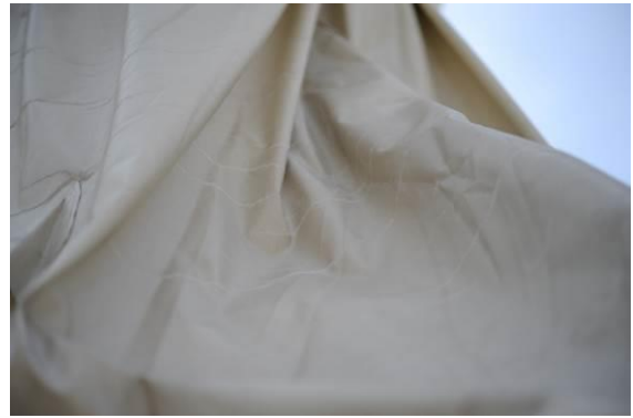
Abb. 112 Netzartig verlaufenden Haarrisse, Foto: ©Haselberger
