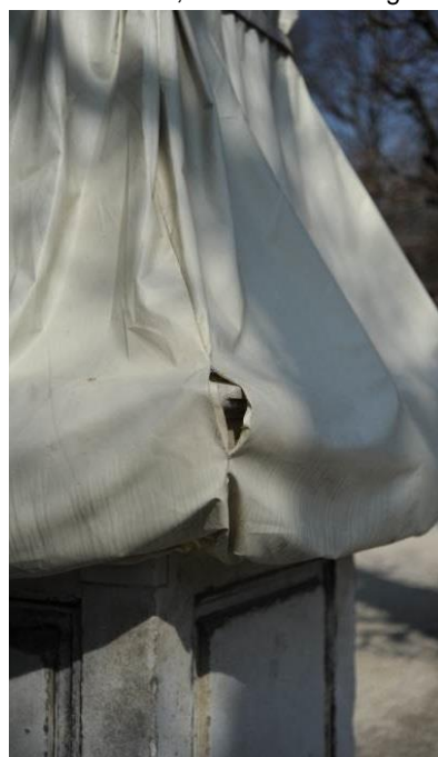
Abb. 110 Lochbildung infolge fehlen- dem Reibungsschutz der Ecke, Foto: ©Haselberger
