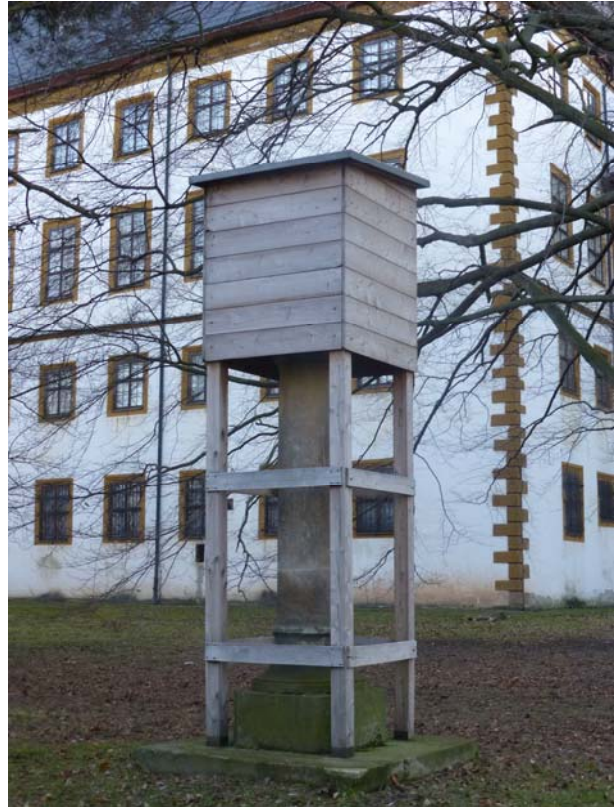
Abb. 2: Holzeinhausung auf Stelzen zum Schutz der oberen Säulenbekrönung im Schloss Friedenstein in Gotha
