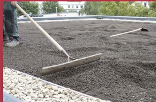
... gleichmäßig verteilt, hier eingerahmt von einem Kiesstreifen.
