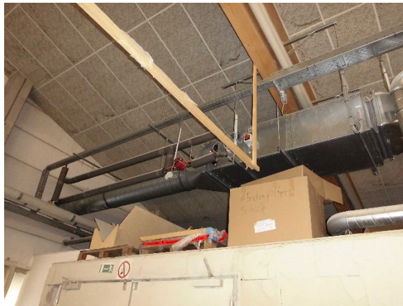
Frischluftzufuhr mit Heizregister
