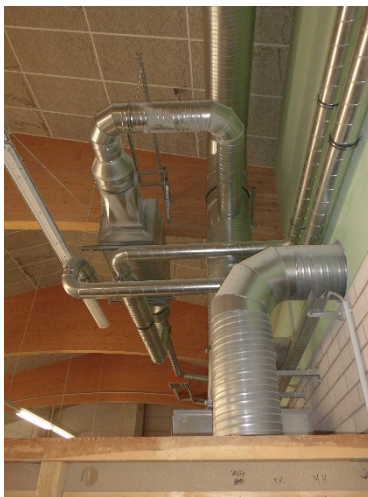
Anbindung Absaugrüssel an die Absauganlage
