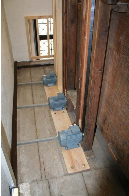
Abb. 48 Getriebeeinheiten der motorischen Aufzugsanlage
