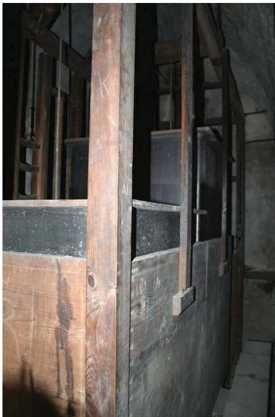
Abb. 41 Balganlage Hinterseite in vorgefundinem Zustand und Schimmelflecken
