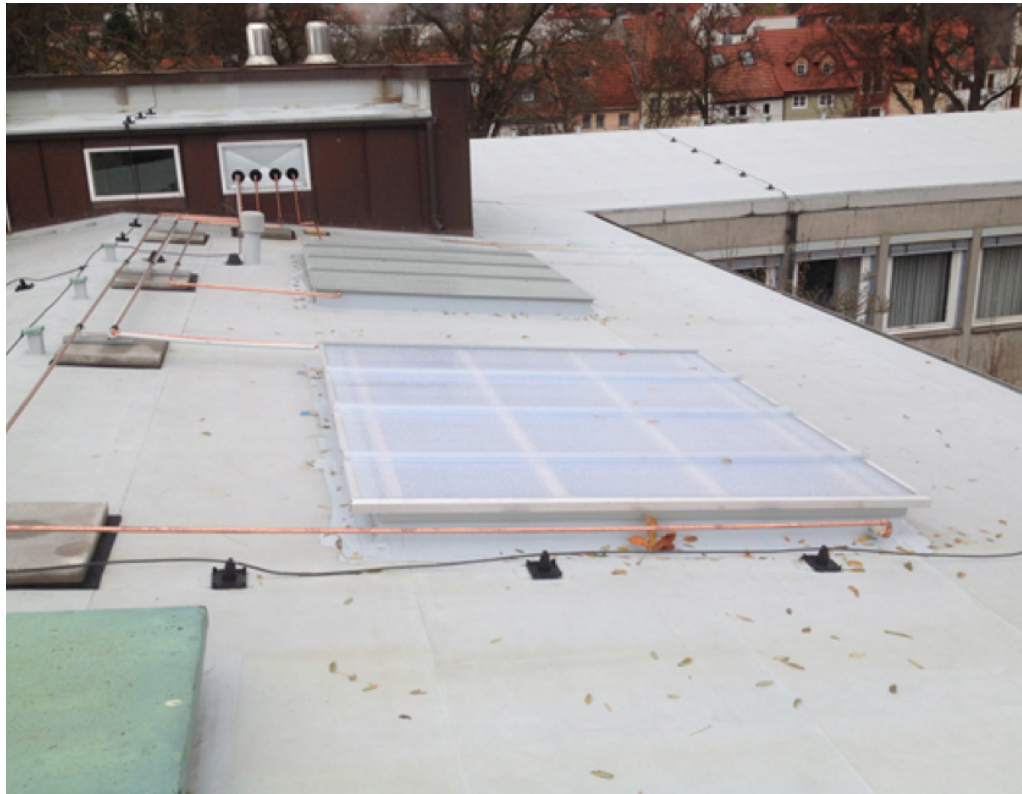
Versuchsaufbau der Dachkollektoren vorne Deckung mit Polycarbonat hinten Deckung mit Stehfalzblech
