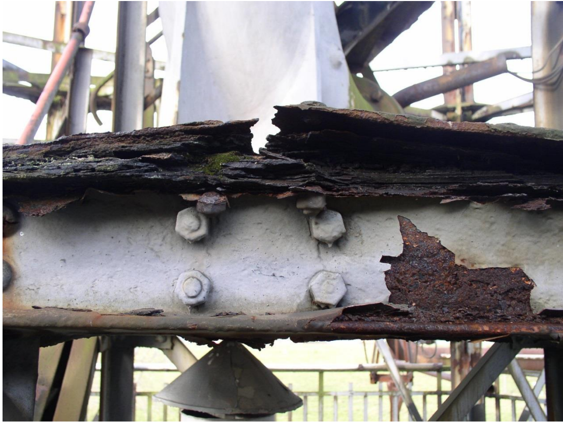
Aufrostung und abgängige Altbeschichtung, Foto: HIG – Hempel Ingenieure GmbH
