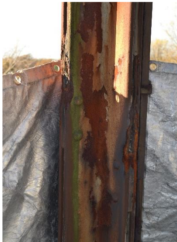
Unbehandelte Oberfläche Foto: HIG – Hempel Ingenieure GmbH
