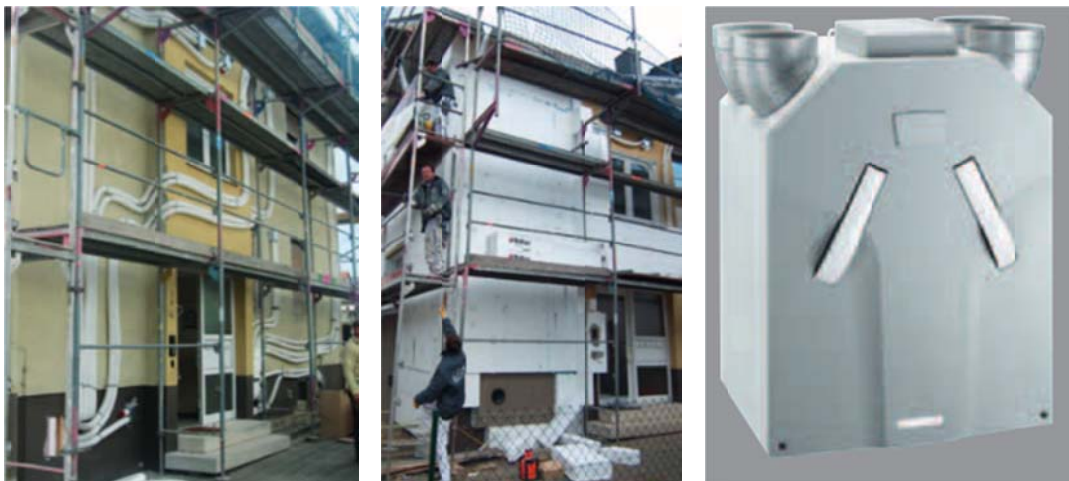
Abbildung 4.12-1: ComfoAir 350 mit Leitungsführung über die Fassade, Quelle: [Zehnder, 2013]
