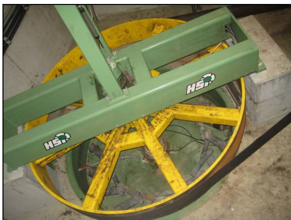
Foto 11 Turbine: Riemscheibe mit Riementrieb und Traverse, 14.02.2011
