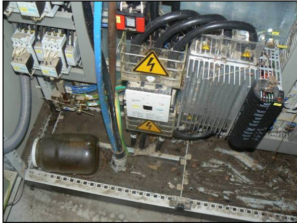
Foto 13 Steuerschrank der Turbinensteuerung mit Hochwasserschaden, 24.08.2010
