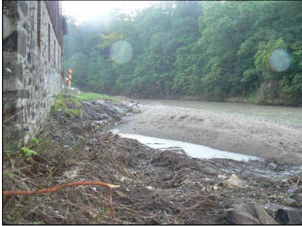
Foto 5 Kolk/ Verfrachtungen und Treibgutablagerungen unterhalb des Fischaufstiegs/ Sägewerks, 24.08.2010
