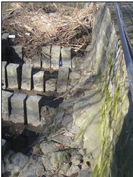
Foto 7 Mit Treibgut versetzter Fischaufstieg, 14.02.2011
