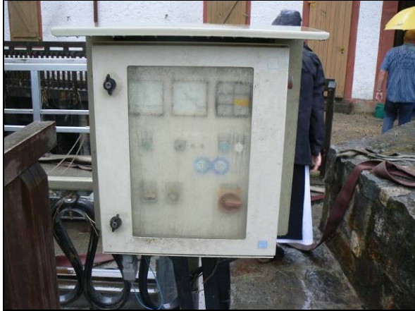
Foto 16 Defekte Steuerung der RAA, 24.08.2010
