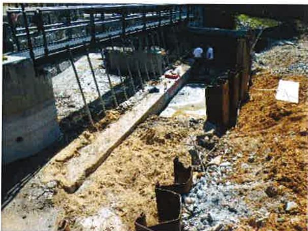
Foto 11 teilweise verfüllte Baugrube durch Umlagerung des Dammbaumaterials nach Hochwasser 15.08.2013
