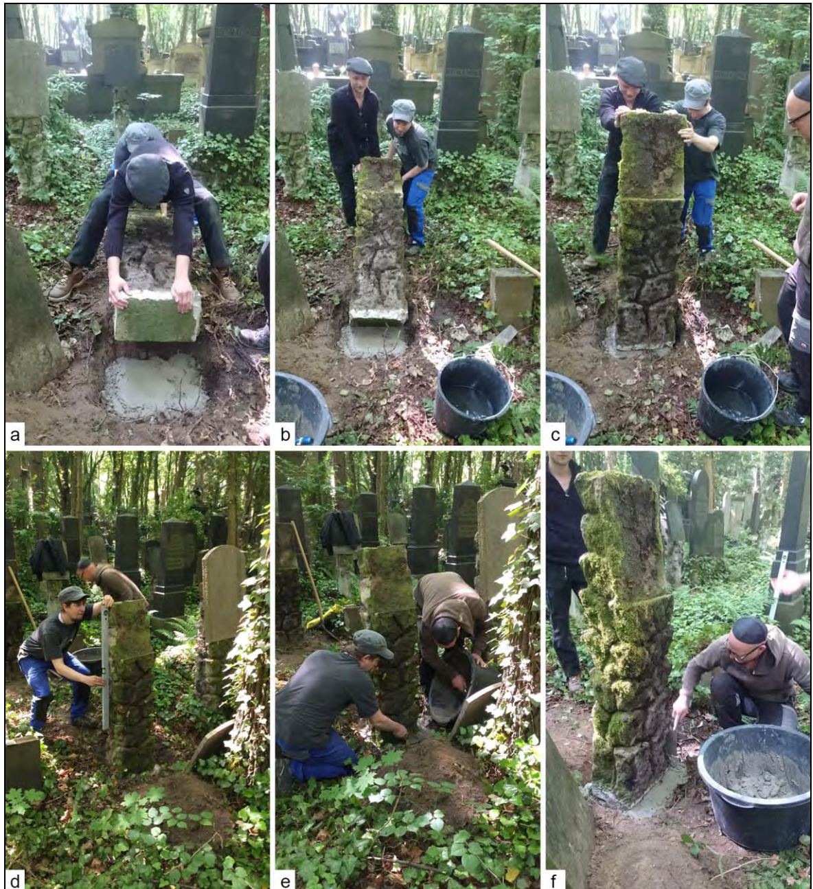
Abb. 79: Instandsetzung von Pultsteinen auf dem Jüdischen Friedhof Weißensee: Aufrichten des Sockelpfeilers; a. b. c. Aufrichtvorgang; d. senkrecht ausrichten mit Wasserwaage und Lot; e. f. Vermörteln des Auflagers; Fotos: O. Zenker.
