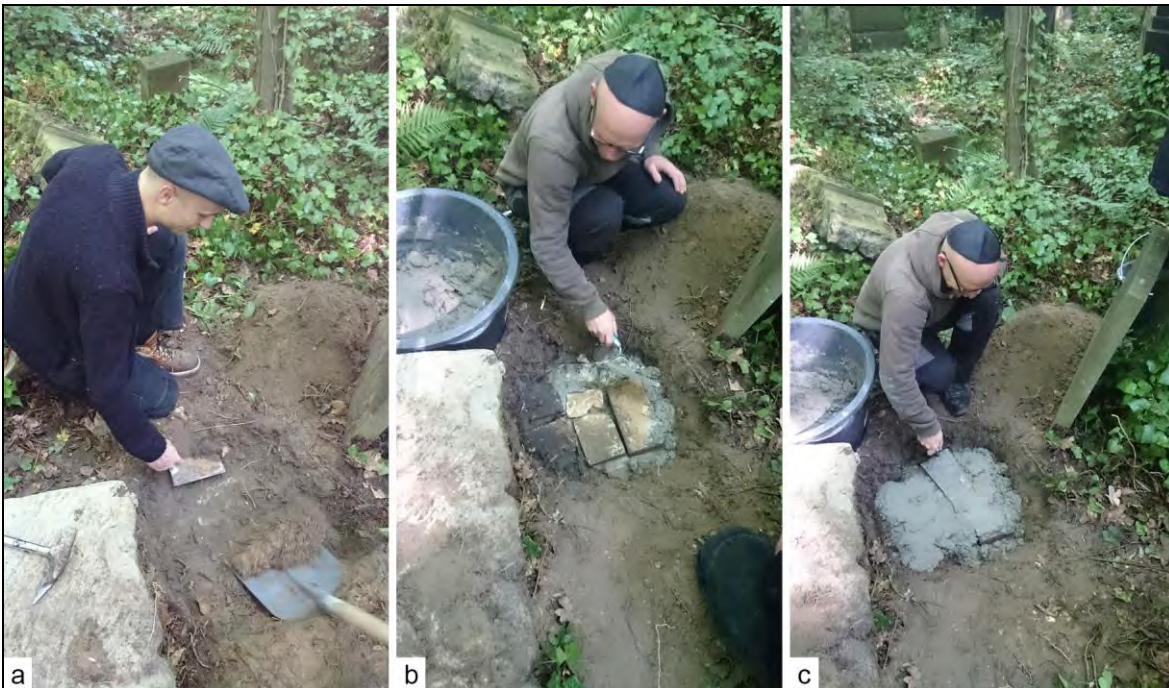
Abb. 78: Instandsetzung von Pultsteinen auf dem Jüdischen Friedhof Weißensee: Reparatur des Fundaments; a. Freilegen; b. c. Konsolidierung; Fotos: O. Zenker.
