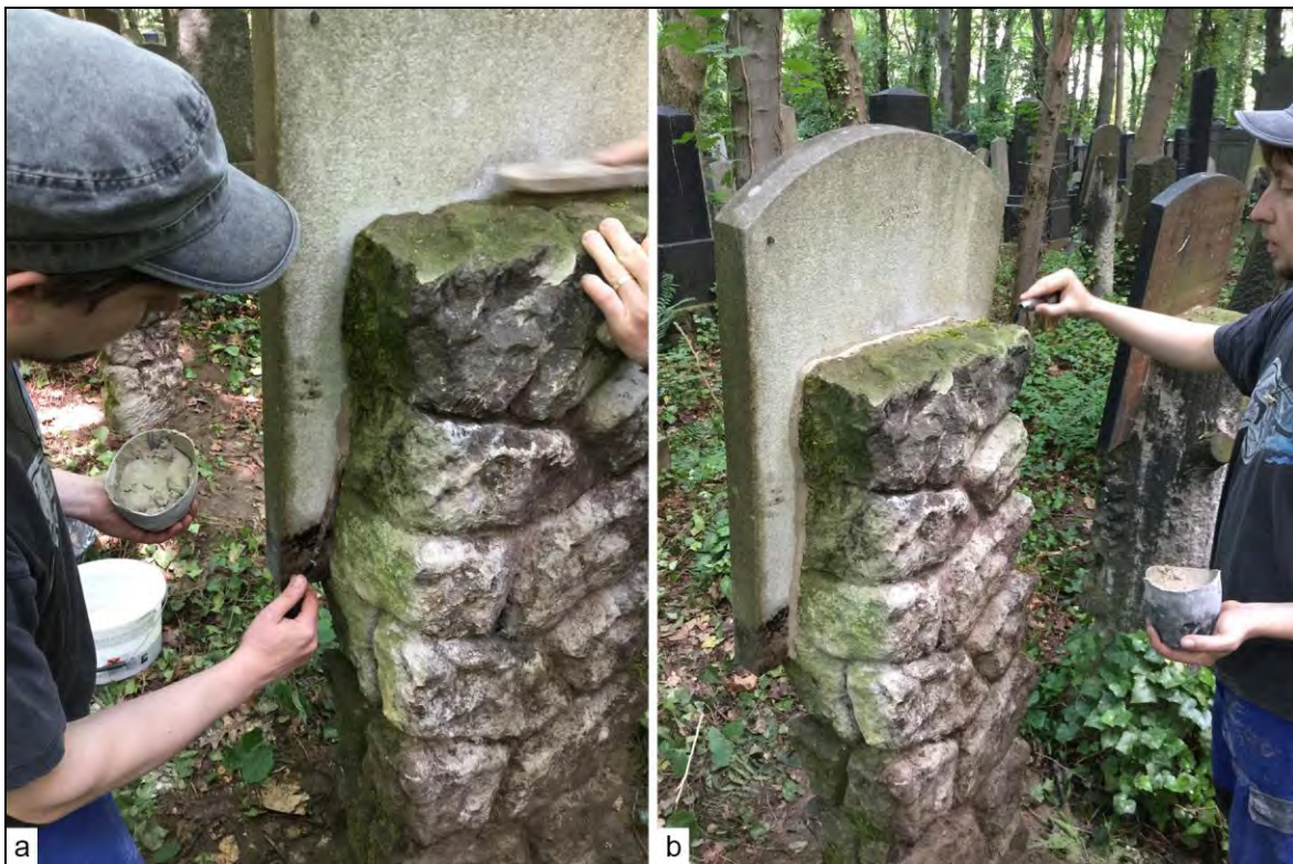
Abb. 84: Instandsetzung von Pultsteinen auf dem Jüdischen Friedhof Weißensee: Reinigen und Verschließen der Auflagerfuge; Fotos: O. Zenker.
