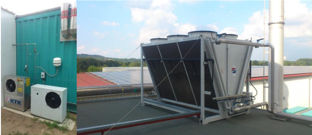
Abbildung 7: links: Kaltwassersatz rechts: Rückkühlwerk
