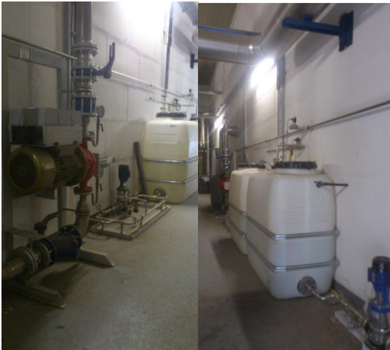
Abbildung 8: Kreislaufpumpe, Druckhaltung Kühlkreislauf, Besprühung
