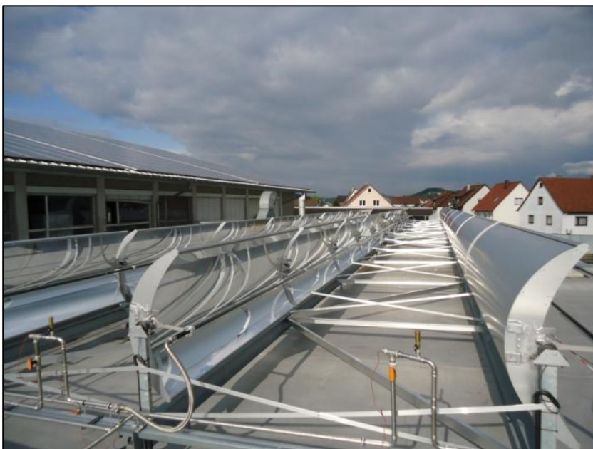
Abbildung 28: Fertiggestellte Parabolrinnenanlage I
