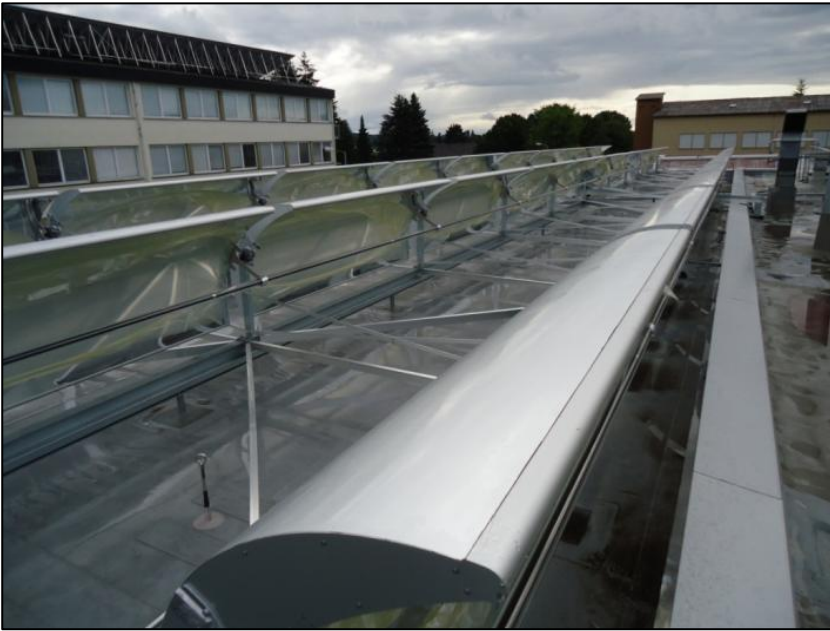
Abbildung 26: Verbaute Parabolrinnen und Absorberrohr
