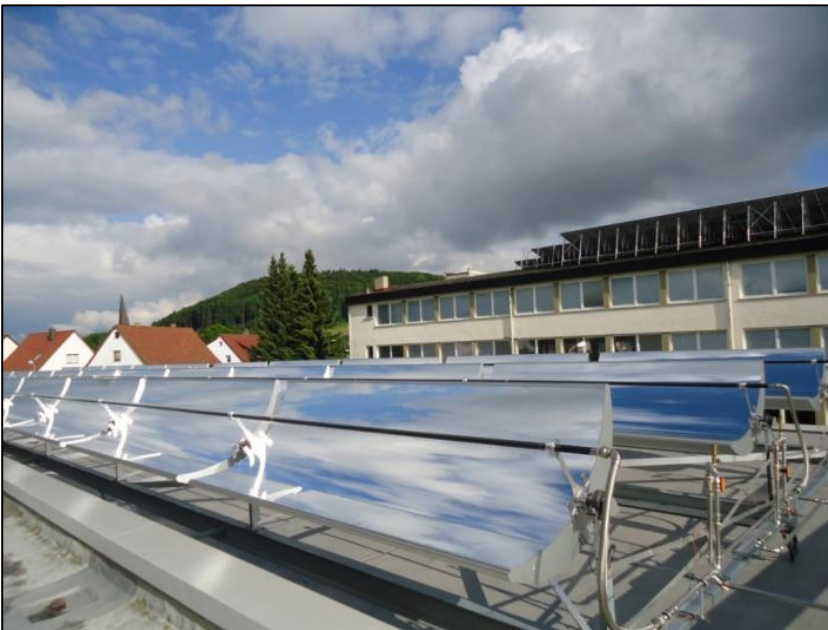
Abbildung 29: Fertiggestellte Parabolrinnenanlage II
