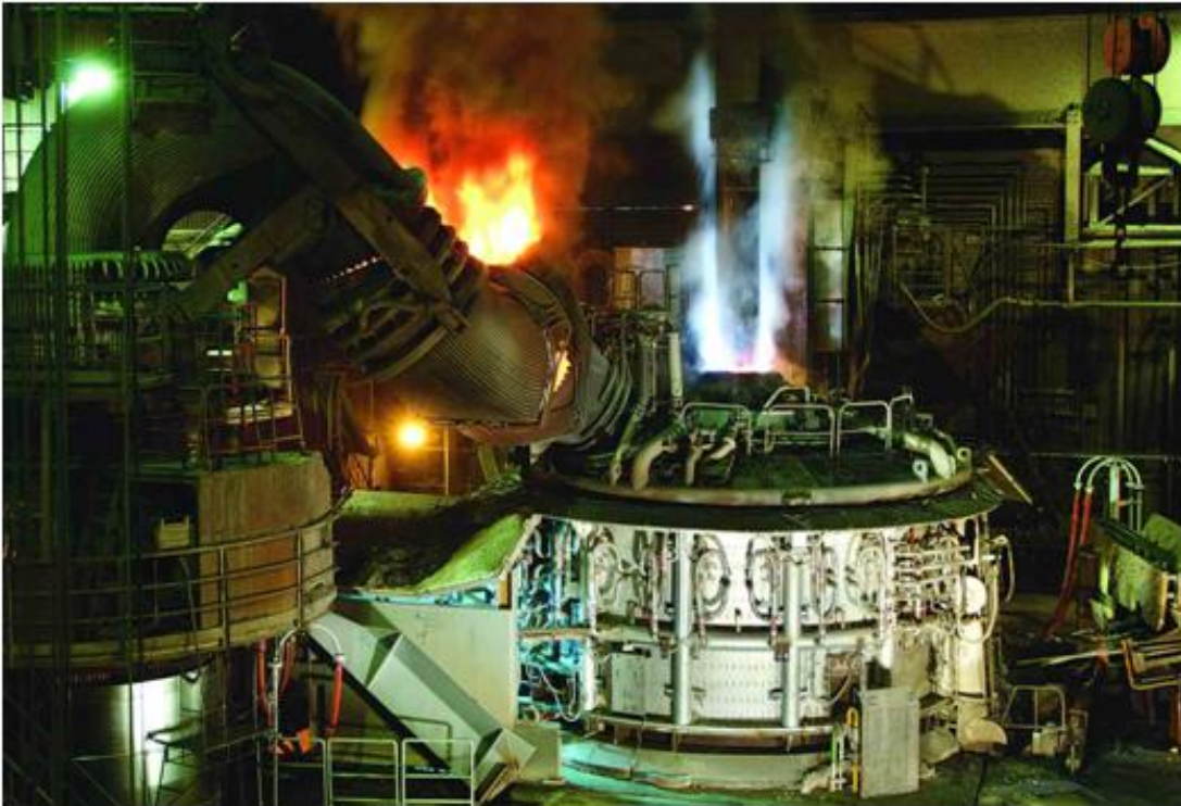
Bild 1: Elektroofen der Georgsmarienhütte
