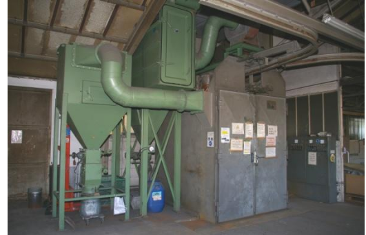
Abb. 7 Strahlanlage, 20 Jahre alt, zur Vorbehandlung von Rohteilen
