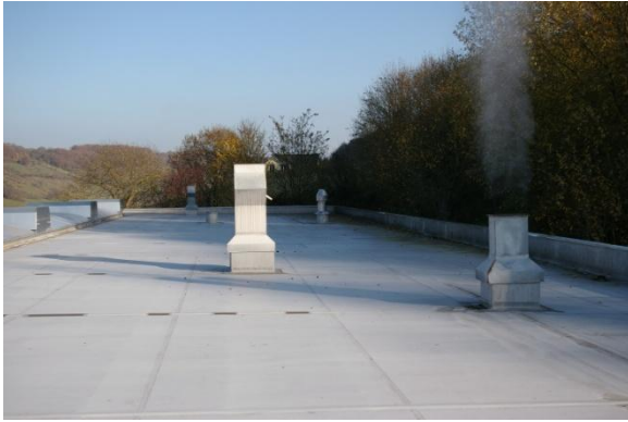
Abb. 14 Ungenutzte Abluftströme entweichen ins Freie
