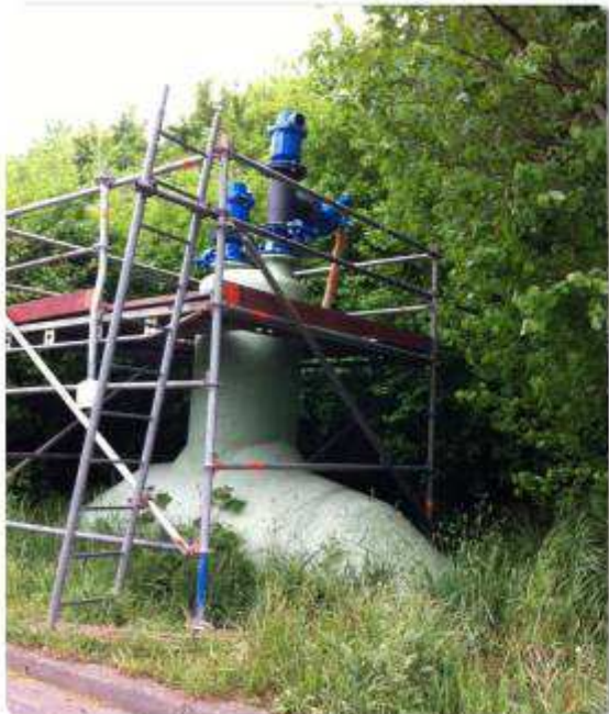
Sümpfungswasserleitung mit Entlüftungsventil Entnahmestelle für Probetrieb (Schlauch)
