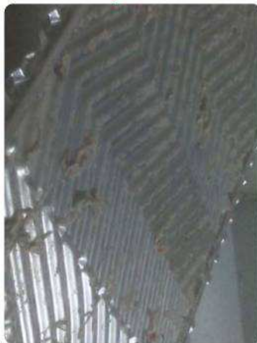
rechts & links: Verschmutzter Platten-Wärmetauscher nach ca. 1 Woche
