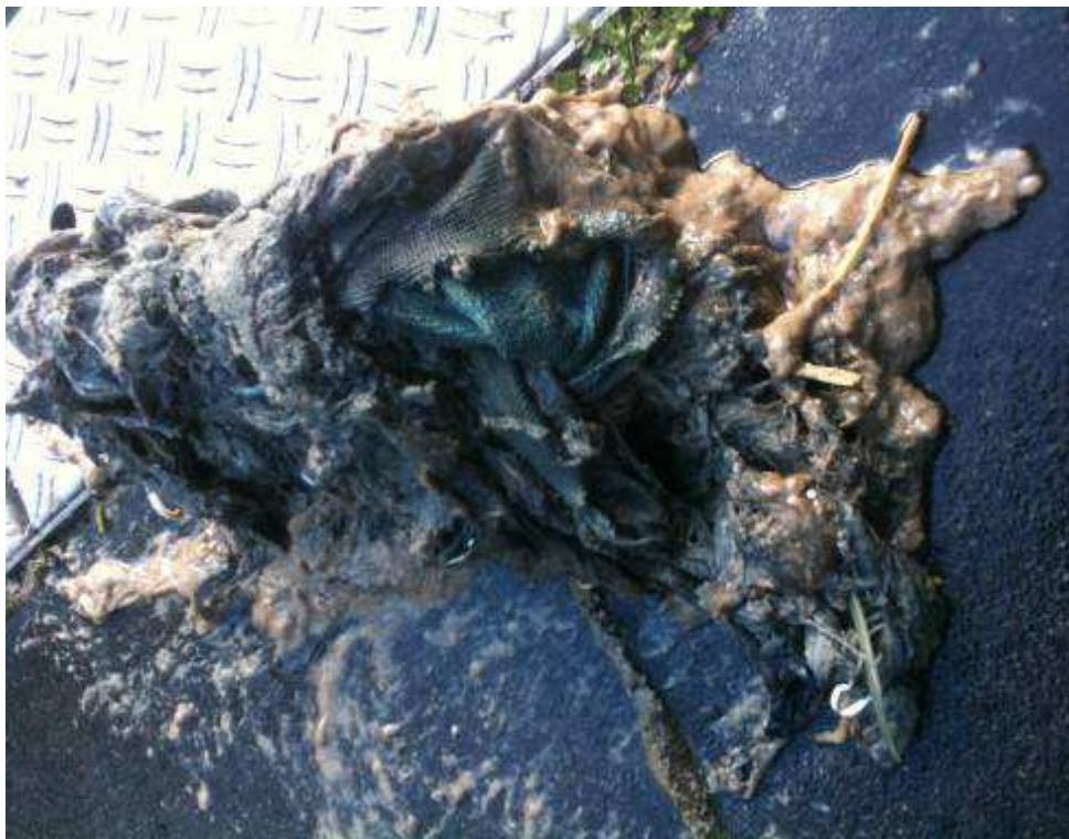
Abb. 7: Verstopfung der Tauchpumpe durch eine Brandschutz-/Schweißschutzdecke und Putzlappen
