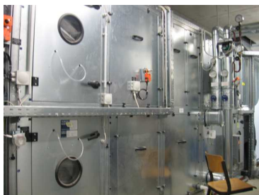
Abbildung 77: Lüftungsanlage Küche Mensa
