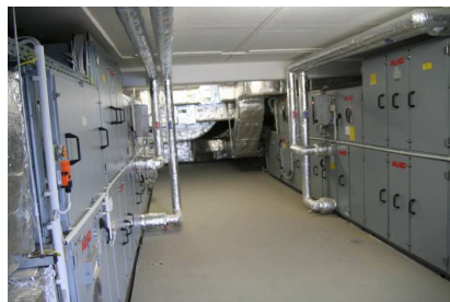
Abbildung 70: Lüftungsanlagen PH Neubau
