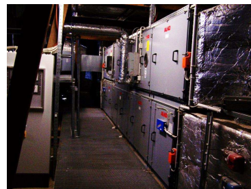
Abbildung 71: Lüftungsanlage Altbau Aula
