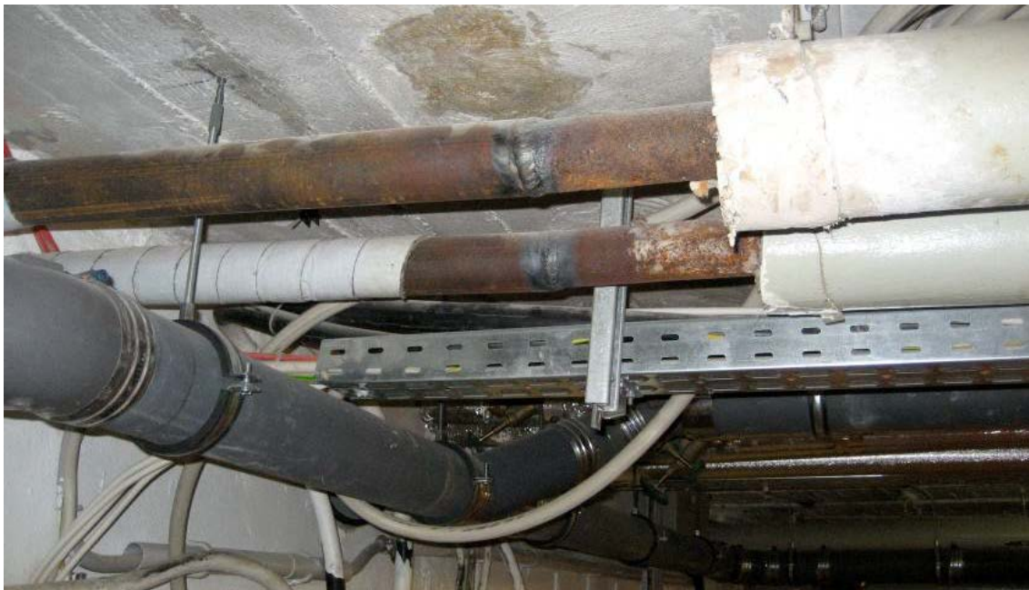
Bild 19 Teilweise ungedämmte Versorgungsleitungen im Untergeschoss
