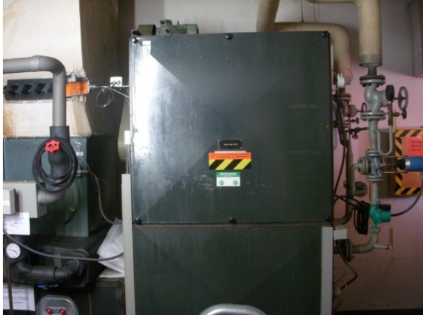
Bild 22 Lüftungsanlage Roter Saal
