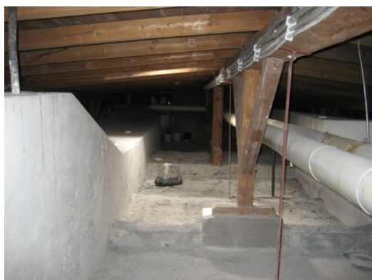
Bild 24 Unsanierte Geschossdecke (Zwischentrakt)
