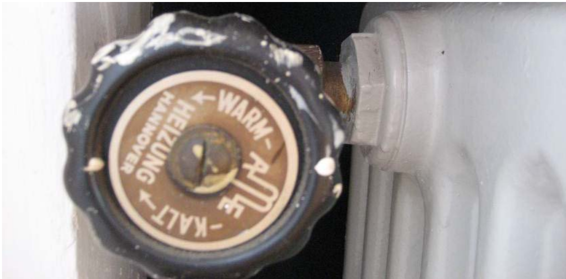
Bild 20 Regelung der Heizung im Blauen und Roten Saal
