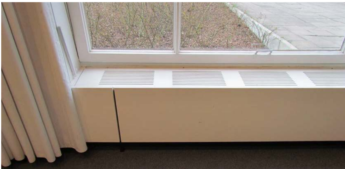
Bild 21 Regelung der Heizung im Neuen Saal schwer erreichbar
